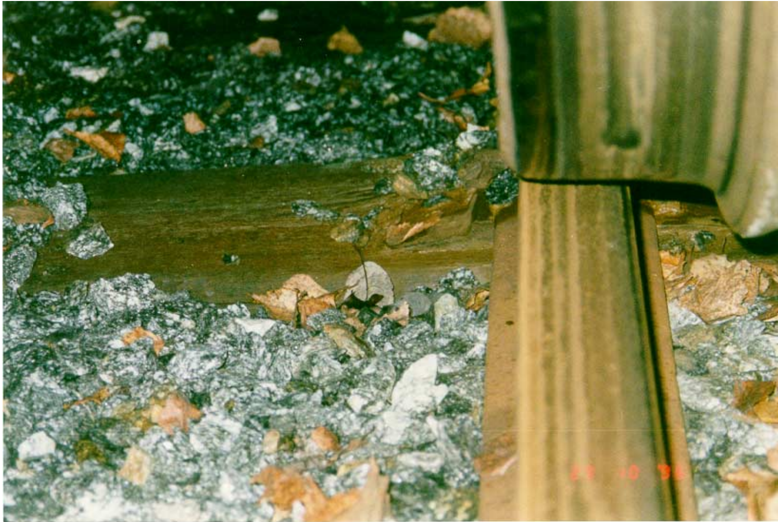
Kuva 8. Toiseksi takimmaisesta öljyvaunun (51962330:n) takimmaisesta pyöräkerran vasen pyörä. Pyörä on lähes normaalisti kiskolla. Kuvassa olevan pyörän pari on seuraavassa kuvassa (kuvassa 9).
