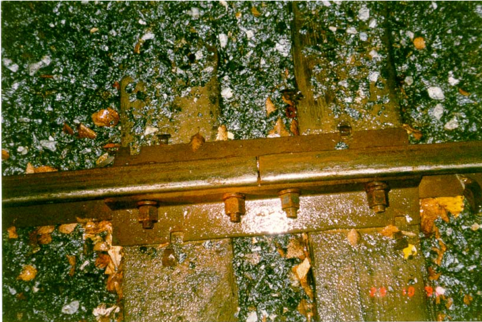
Kuva 4. Jatkos, josta suistuminen alkanut; vasen kisko. Huomaa aluslevyn siirtyminen irti ratanauloista kiskon sisäpuolella.
