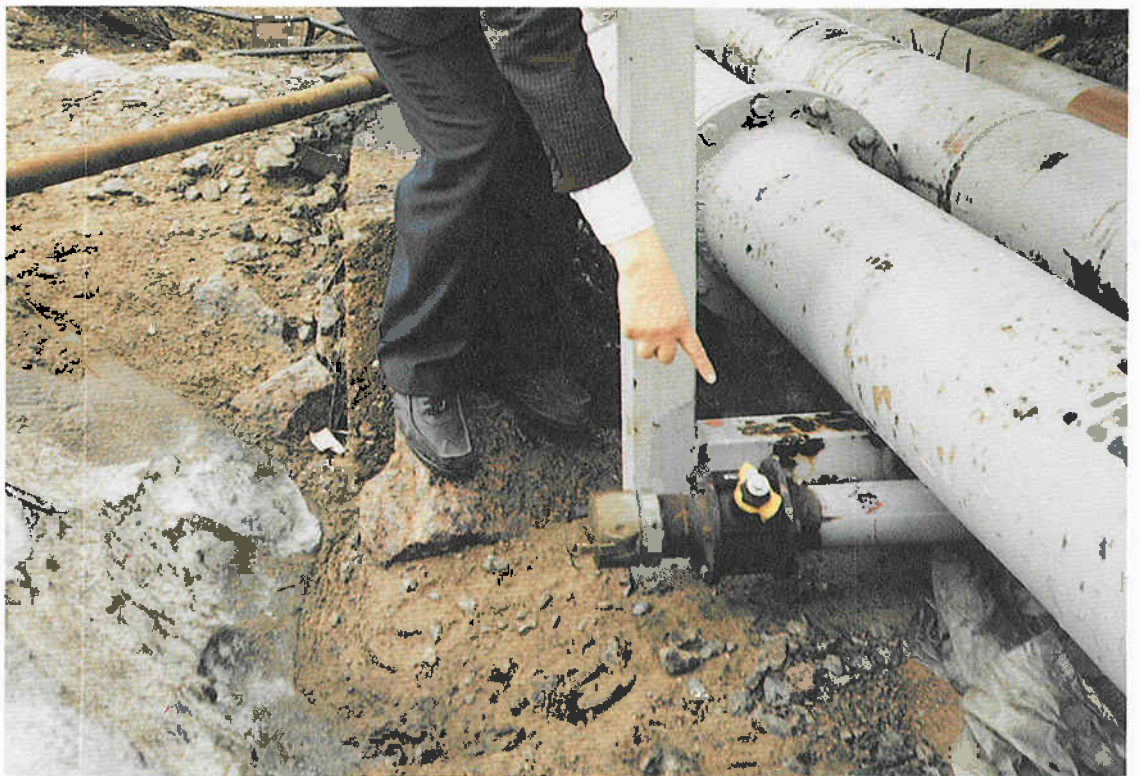
Sama venttiili kuvattuna 18.4.1988. Venttiilien kahvat on nyttemmin poistettu. Kuva: Eero Avela
