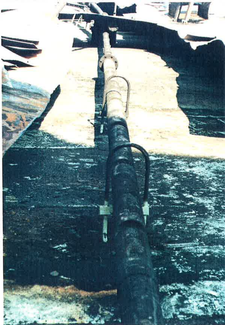
KUVA 13. Pohjassa oleva vaakasuora vesitysputken osa. Päällä oleva katto on leikattu auki
