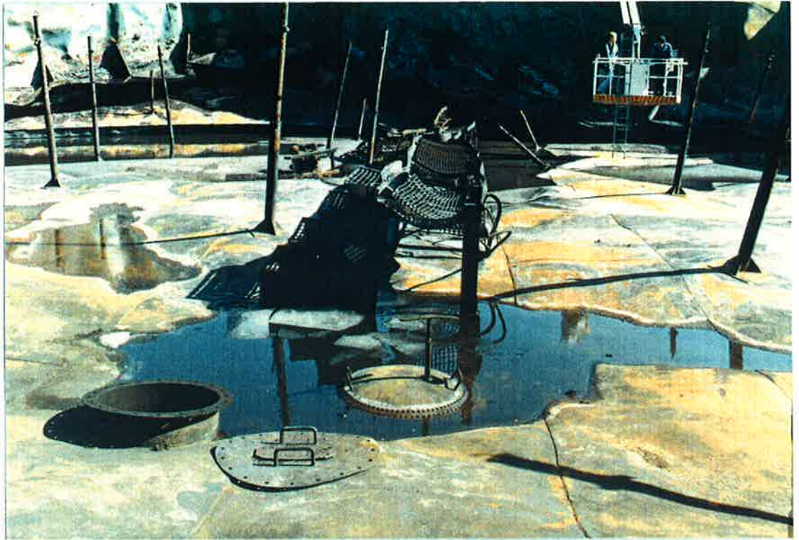
KUVA 10. Tilanne katolla palon jälkeen. Vesityskaivossa on kansi päällä. Sen sijaan miesluukun kansi on luukun vieressä. Miesluukun 18 cm:n korkean kauluksen vieressä oli katkaistuja pultteja.
