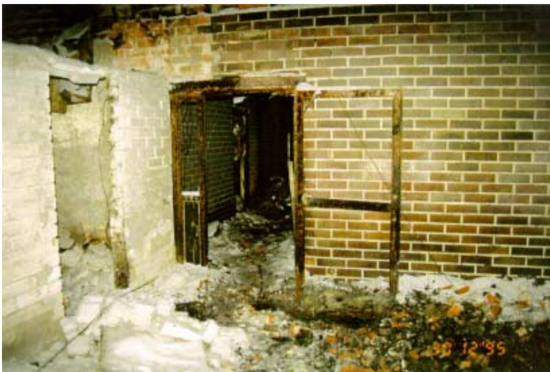
Sisääntuloaulan vieressä olleen takkahuoneen ja vanhan majoitusosan käytävän välissä palon aikana ollut palo-ovi. Vertaa 2.11.1995 kuvatulta videonauhalla otettuun valokuvaan auki olleesta palo-ovesta kohdassa 3.5.
