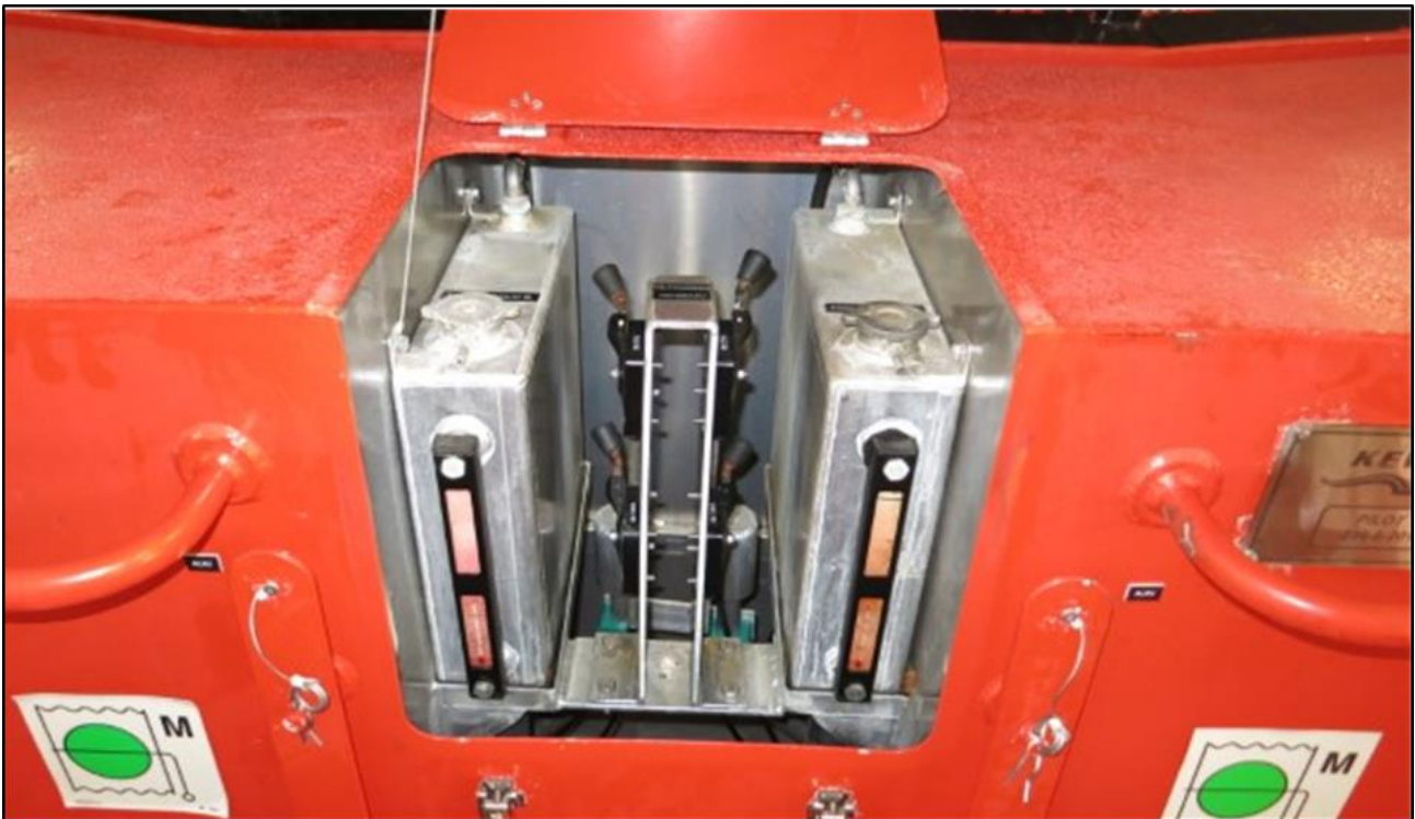
Bild 16. Bränsletankarnas snabbstängningsventiler och stängningshandtagen för luftintagsöppningarna i maskinrummet. (Bild: OTKES)
