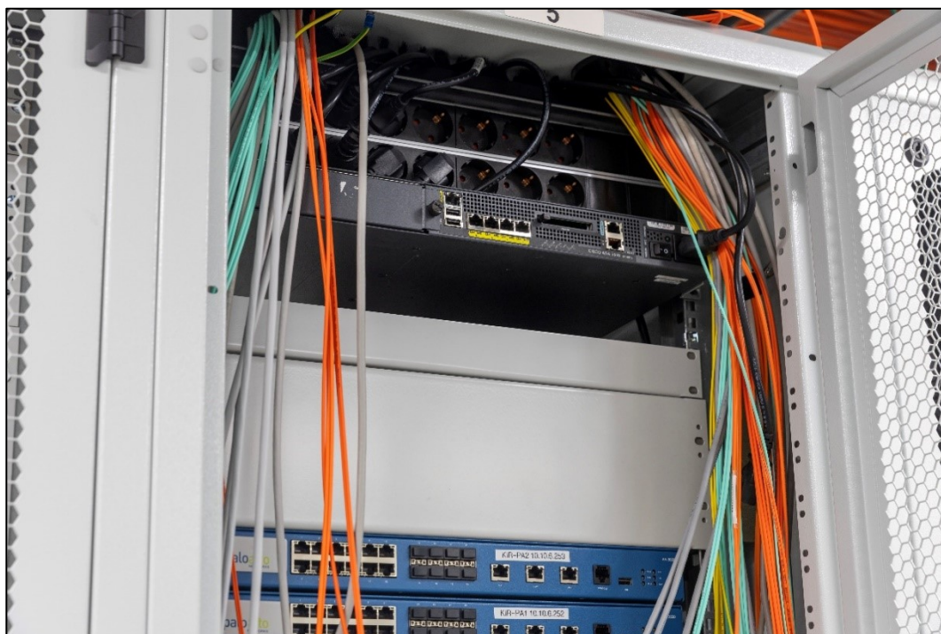
Figur 7. Enhetsskåpet i fostrans- och utbildningssektorns datorhall i oktober 2024. Figuren visar en VPN-reservenhet ASA 5545 som aldrig togs i bruk. ASA 5515 som användes vid dataintrånget låg under den.
