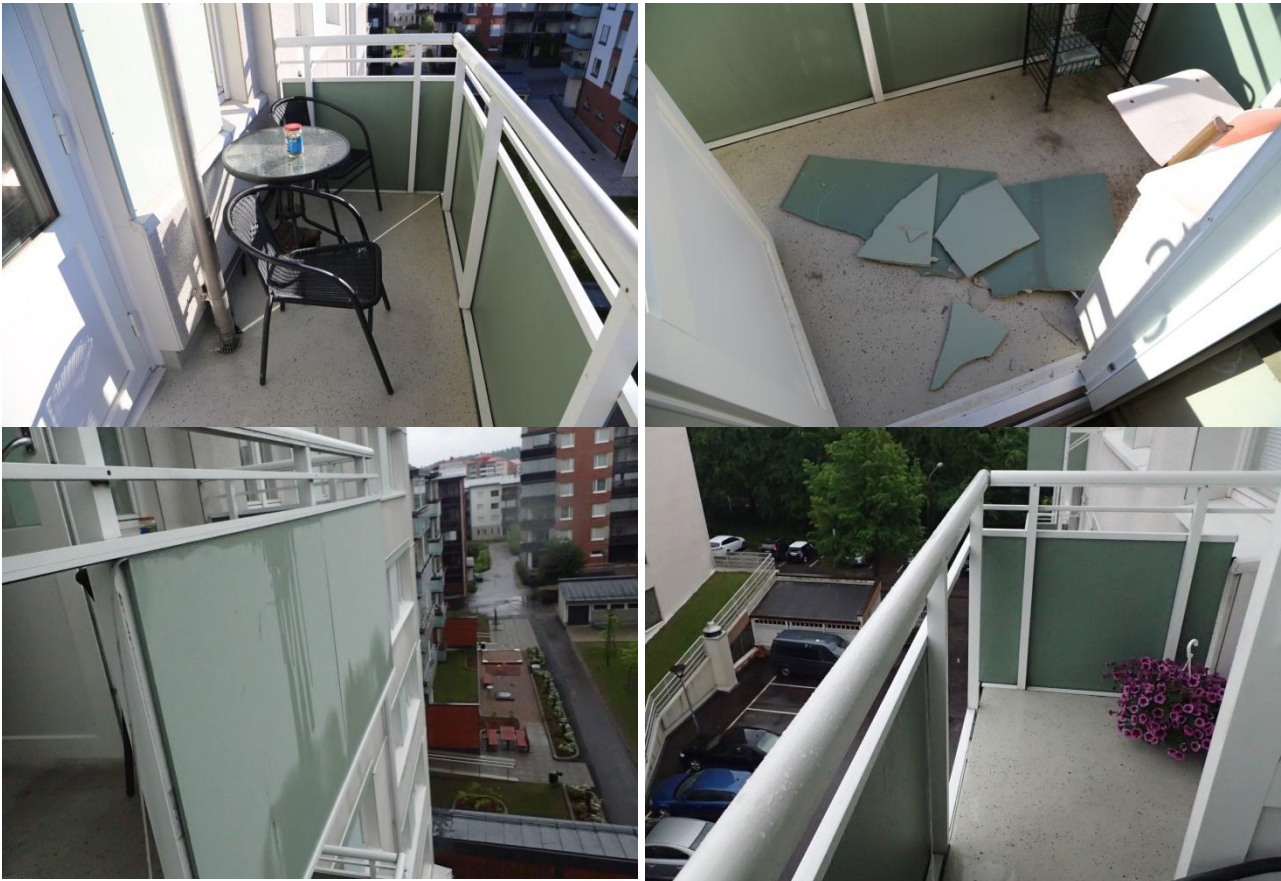
Bild 2. Bilder av balkongen där olyckan inträffade och uppe till höger en bild av bitar av skivan som fallit ner på den underliggande balkongen. (Bilder: övre raden polisen, nedre raden OTKES)
