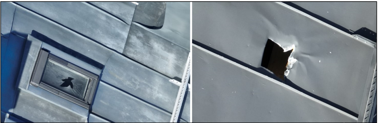
Kuva 10. Läheisten talojen katoilta löytyi vaurioita, jotka olivat todennäköisesti räjähdyksessä sinkoutuneiden kivien aiheuttamia. (Kuvat: OTKES)
