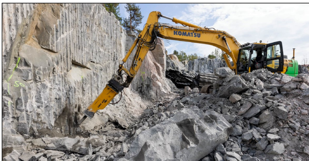
Kuva 5. Räjähdyksessä sinkoutuneet kivet rikkoivat kaivinkoneen ikkunoita. Kaivinkoneen kuljettaja loukkaantui vakavasti. (Kuva: poliisi)
