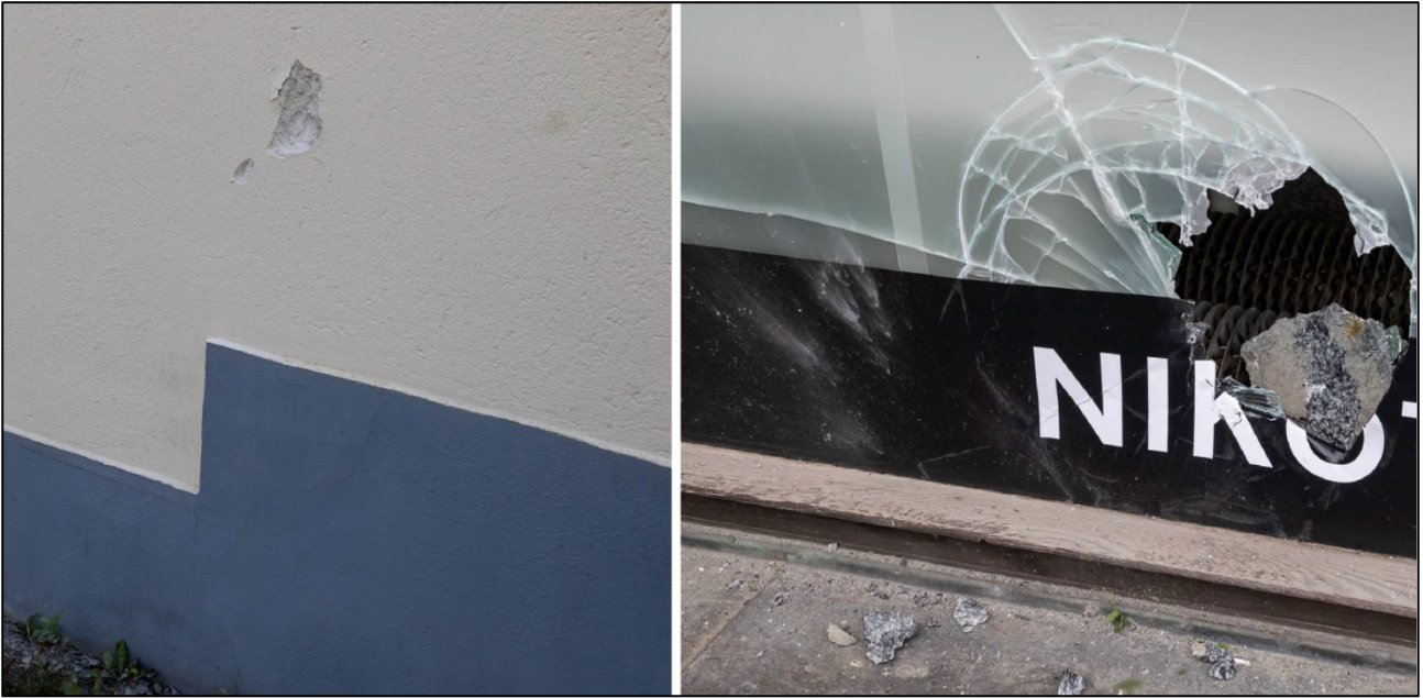
Kuva 9. Onnettomuudessa sinkoutuneiden kivien aiheuttamia vaurioita työmaan lähellä olevien talojen seinässä ja ikkunassa. (Kuvat: poliisi)
