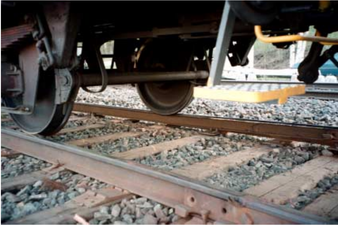
Kuva 7. Tavaravaunujen suistuminen kiskoilta Siilinjärvellä 20.5.2000. Kuvassa 5 näkyvä mutka toiselta puolelta kuvattuna. Pyörän tekemiä jälkiä kiskon hamaran sisäreunassa. Oikea pyörä juuri ja juuri kiskon päällä.
