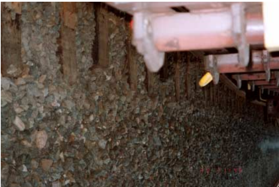
Kuva 6. Tavaravaunujen suistuminen kiskoilta Siilinjärvellä 20.5.2000. Joka kolmas rata-pölkky, eli pölkkyt jossa kisko oli kiinni, on siirtynyt ulkokaarteeseen päin.
