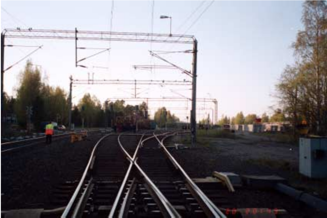
Kuva 3. Tavaravaunujen suistuminen kiskoilta Siilinjärvellä 20.5.2000. Suistuneet vaunut junan tulosuunnasta, vaihteen 3 päältä, kuvattuna. Kiskonkiinnitysten harventaminen oli aloitettu vasemmalla puolella raidetta olevan taaemman koneen kohdalta.
