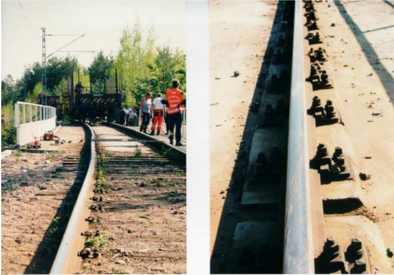
Kuva 4. Raideleveyden muutos sillan kannen alussa. Vaunun takatelin vasemman puoleiset pyörät suistuivat kiskoilta viimeisen puuratapölkyn kohdalla. Telin oikeanpuoleiset pyörät suistuivat kiskoilta vasta betonikannen alettua (oik.). Ensin suistuneet pyörät ovat painaneet vasemman kiskon mutkalle.
