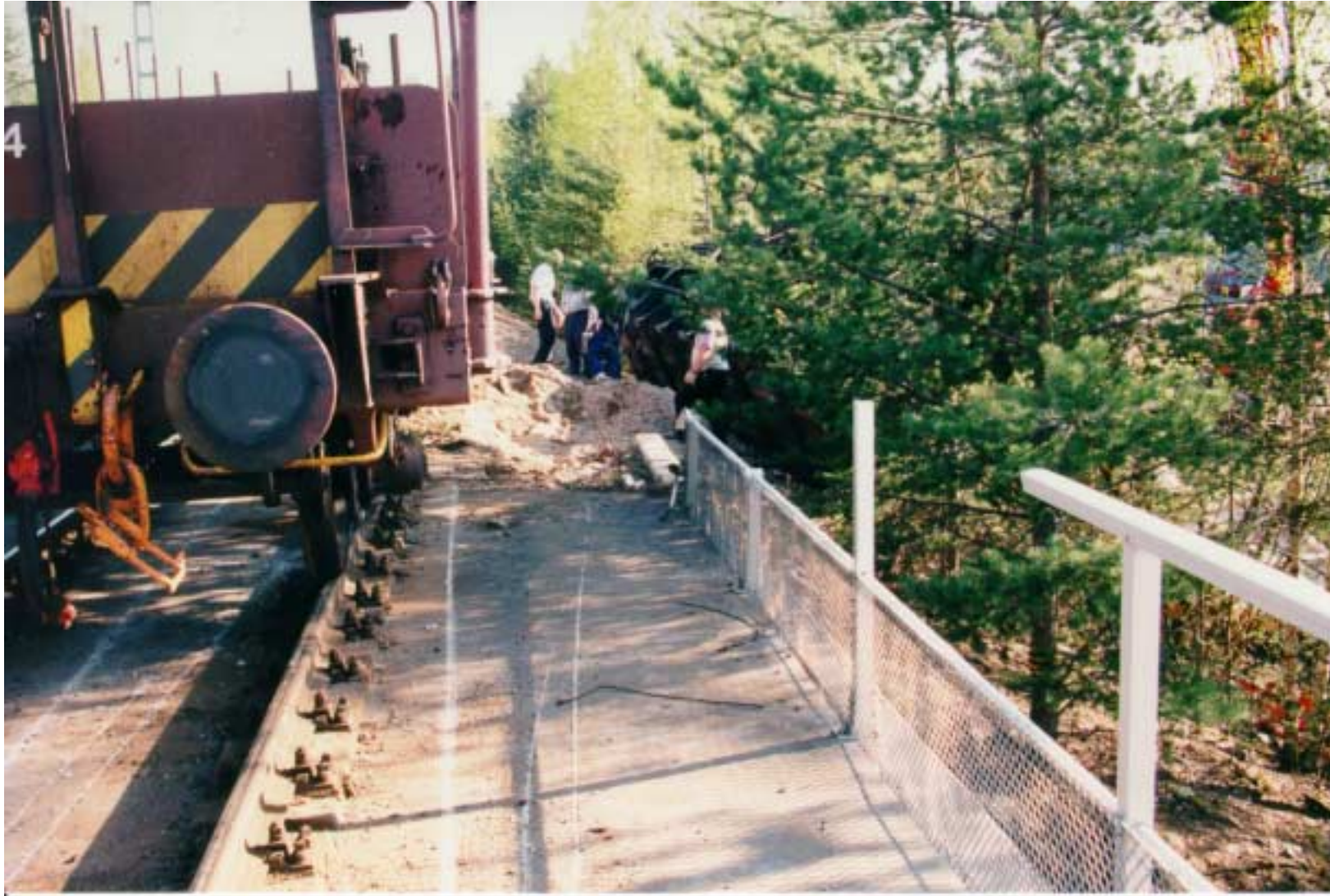
Kuva 3. Sillan betonikannen päättyessä etuteli upposi pehmeään ratapenkereeseen ja vaunu alkoi kaatua. Kuvan vahvemmat jäljet ovat tulleet etutelistä ja heikommat takatelistä. Kaatuva vaunu vei myös osan sillan kaiteesta.
