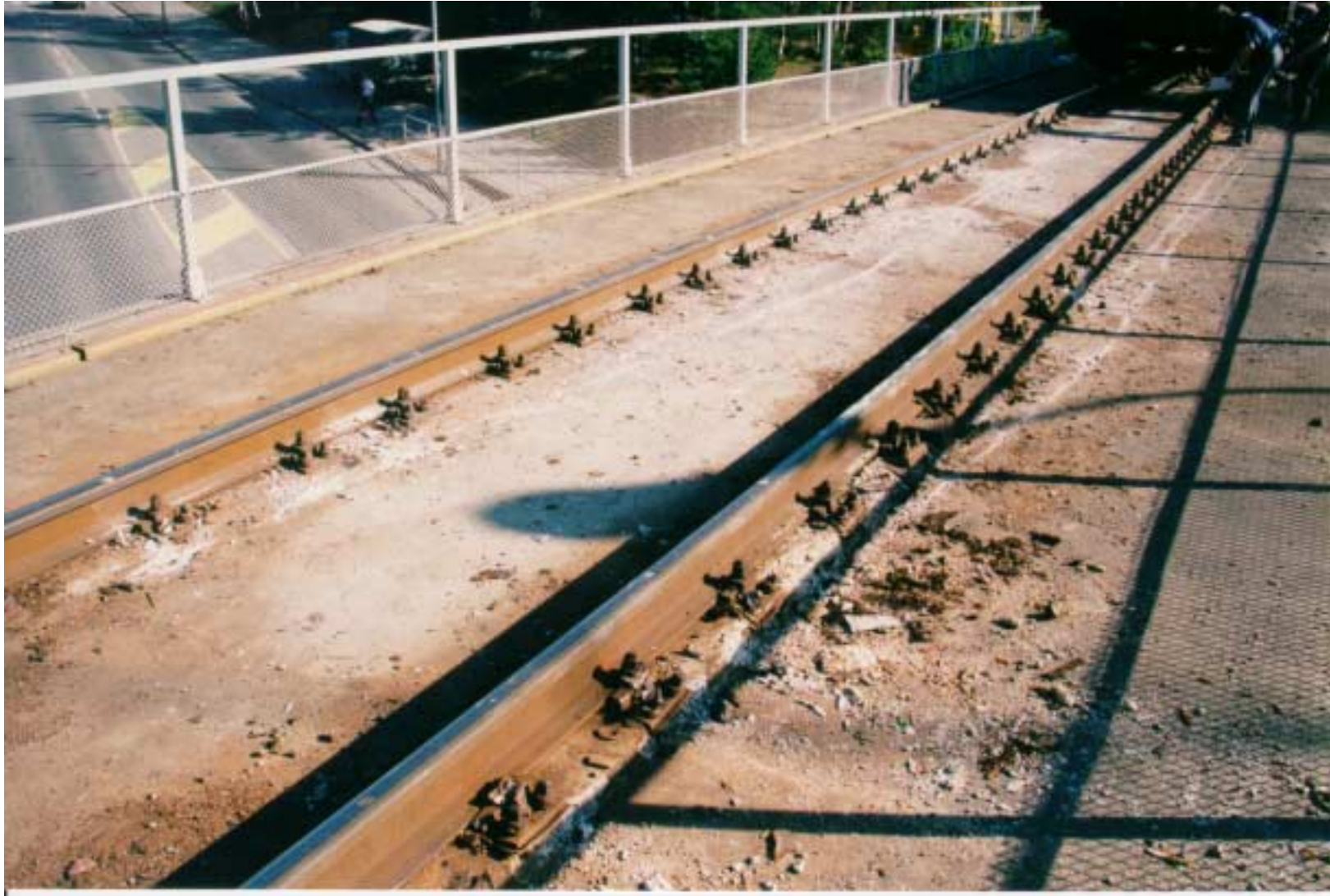
Kuva 2. Suistuneen vaunun etuteli putosi kiskoilta heti takatelin suistuttua. Suistuneen vaunun takana ollut ja kiskoilla pysynyt välivaunu esti lasivaunun suistumisen alla näkyvälle Kerkkolankadulle.
