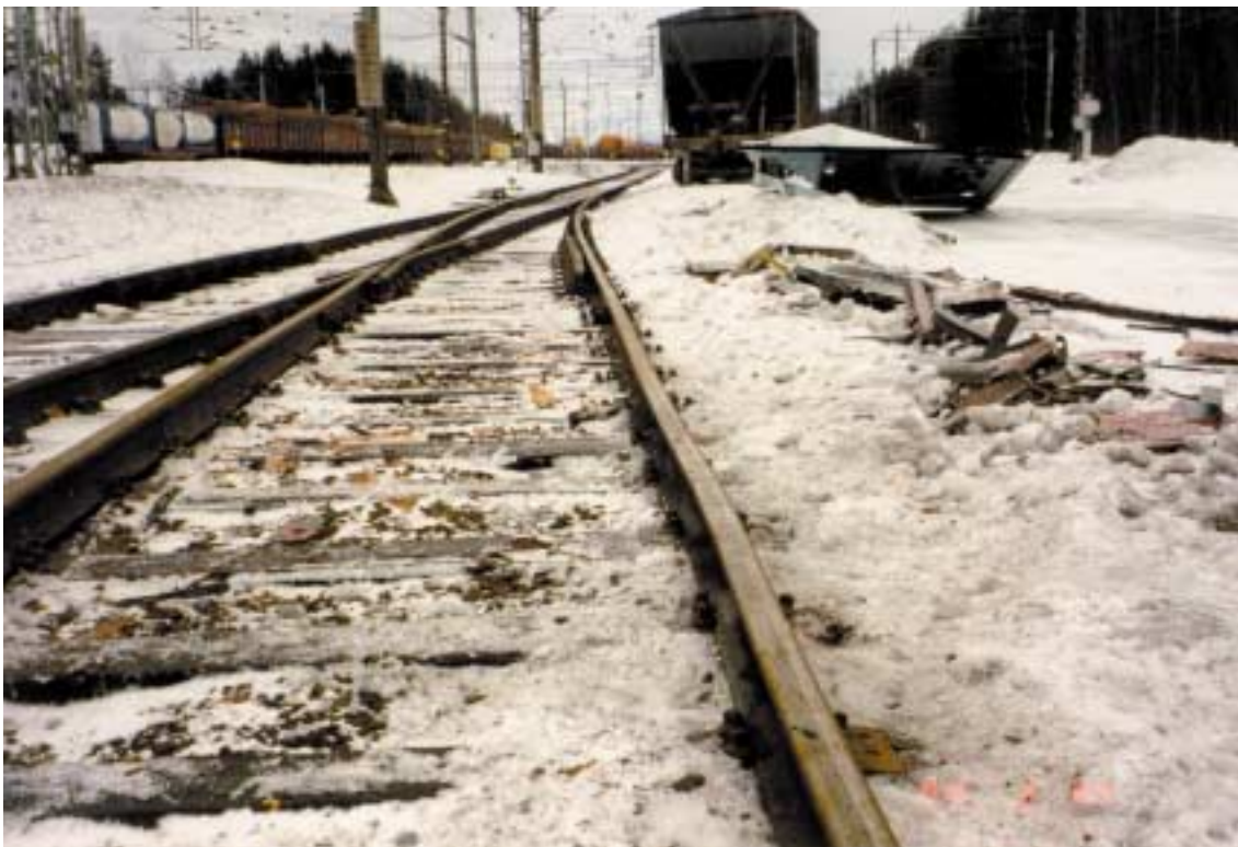
Kuva 7. Vaihtotyöveturin työntämän vaunuryhmän törmääminen tavarajunan kylkeen Kouvolassa 28.2.1998. Raiteen 229 itäpäässä vähän vääntynyt kisko.
