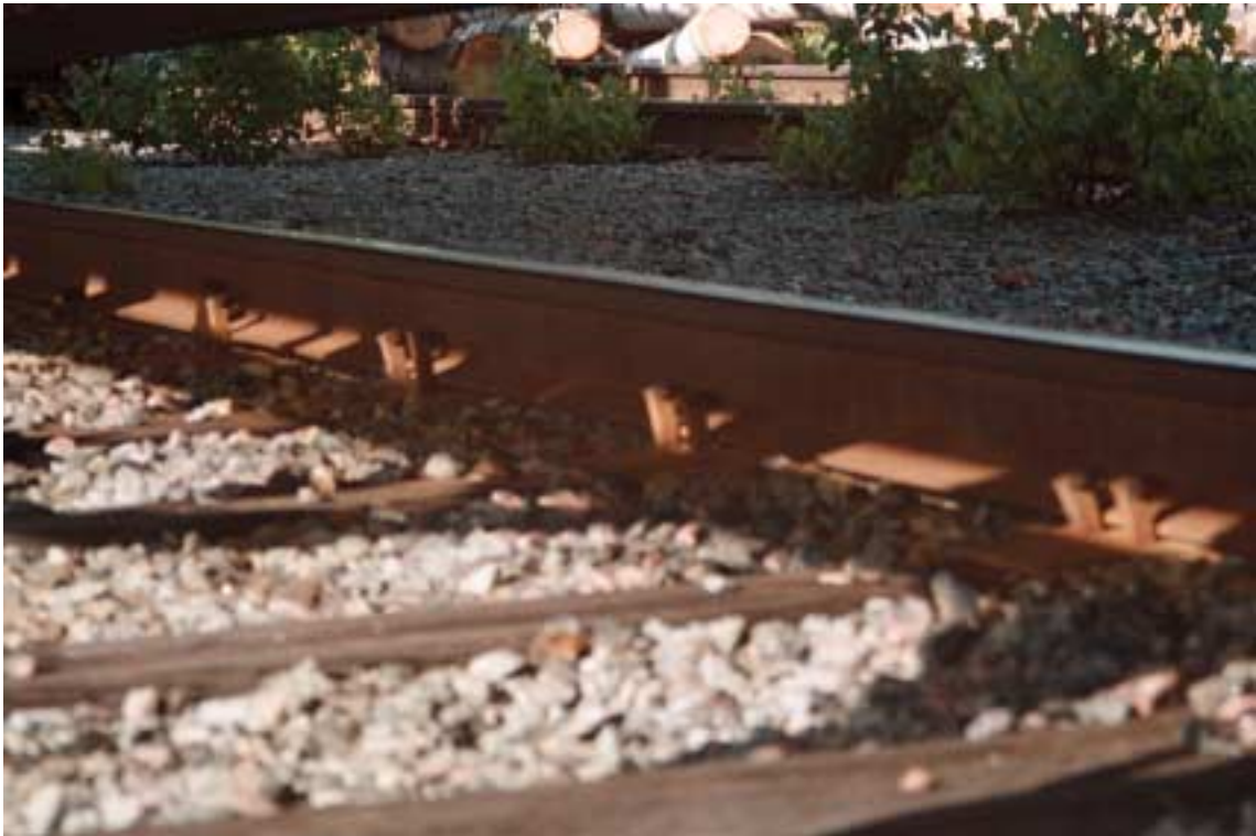
Kuva 5. Viiden puutavaravaunun suistuminen Saaren liikennepaikalla 29.6.2000. Pölkkyt olivat huonokuntoisia, minkä vuoksi kiskot kallistuivat ja osa kiskojen kiinnitysnauloista nousi ylös.
