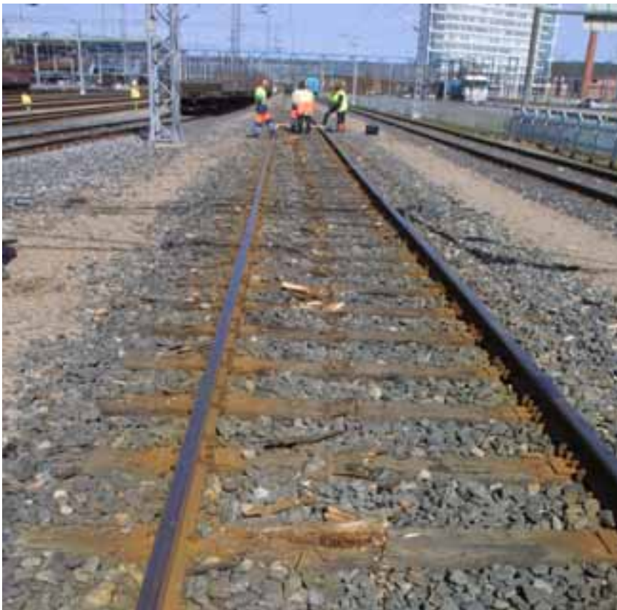
Kuva 3. Neljän venäläisen puutavaravaunun suistuminen kiskoilta Jyväskylän ratapihalla 14.5.2003. Radan vaurioita.
