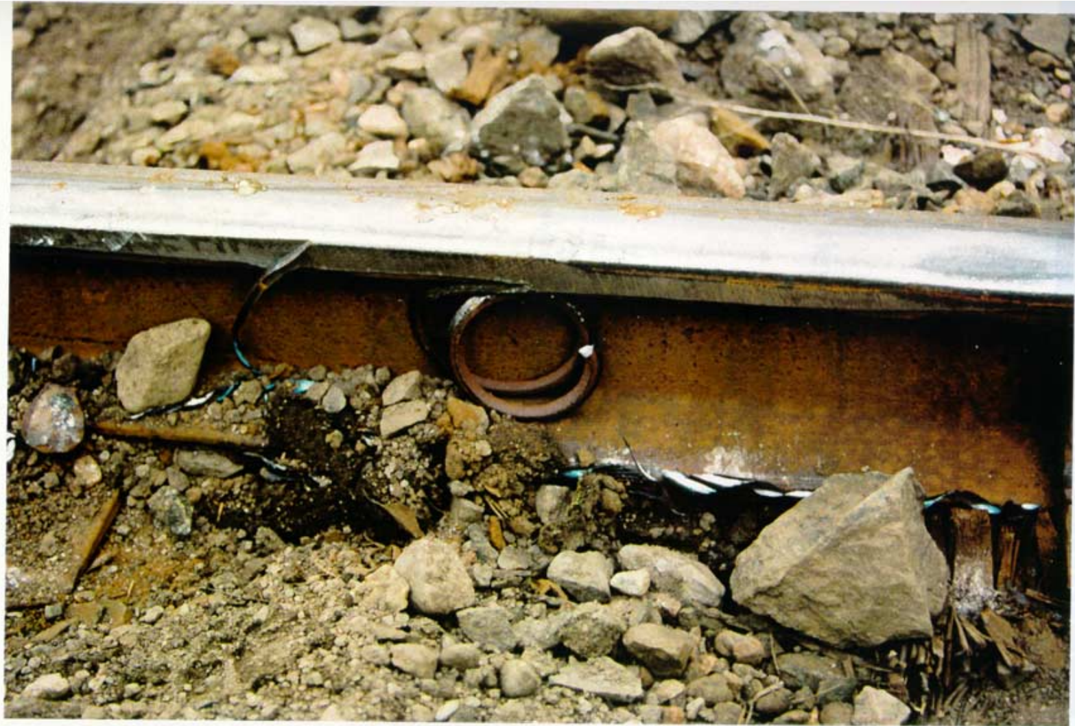
Kiskon ylälaipan sisäreunasta revenneitä kielekkeitä
