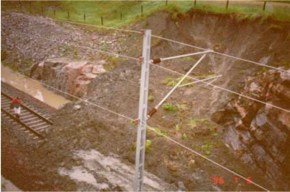
Kuva 1. Märkää savea valui kiskoille kallioleikkauksen kohdalta kalkkipilaristabiloidusta leikkausluiskasta. Savea oli kiskoilla enimmillään lähes kaksi metriä. Lähialueilla havaittiin myös useita muita sortuman alkuja.
