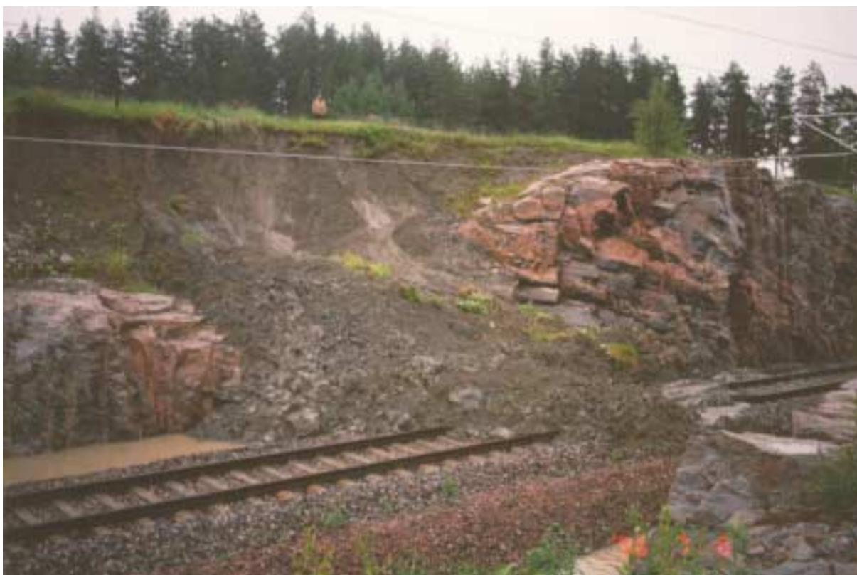
Kuva 1. Leikkausluiskan sortuma Helsinki - Turku radalle Paimiossa 6.7.1996. Maata sortui radalle arvioita 200–300 m 3 .
