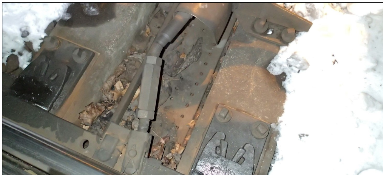
Kuva 26. Vaihteen kääntöavustimen akseli vääntyi suistumisen seurauksena. (Kuva: OTKES)
