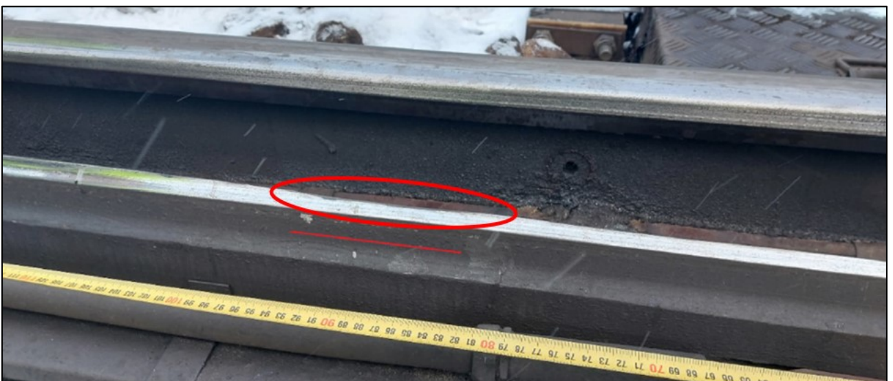
Kuva 24. Vaihteen V171 kielen ja tukikiskon kuluma ja kielessä noin 90 cm päässä kielen kärjestä ollut lohkeama (ympyröity). Lohkeaman pituus on merkitty kuvaan punaisella viivalla. (Kuva: Tampereen yliopisto, Merkinnät: OTKES.)
