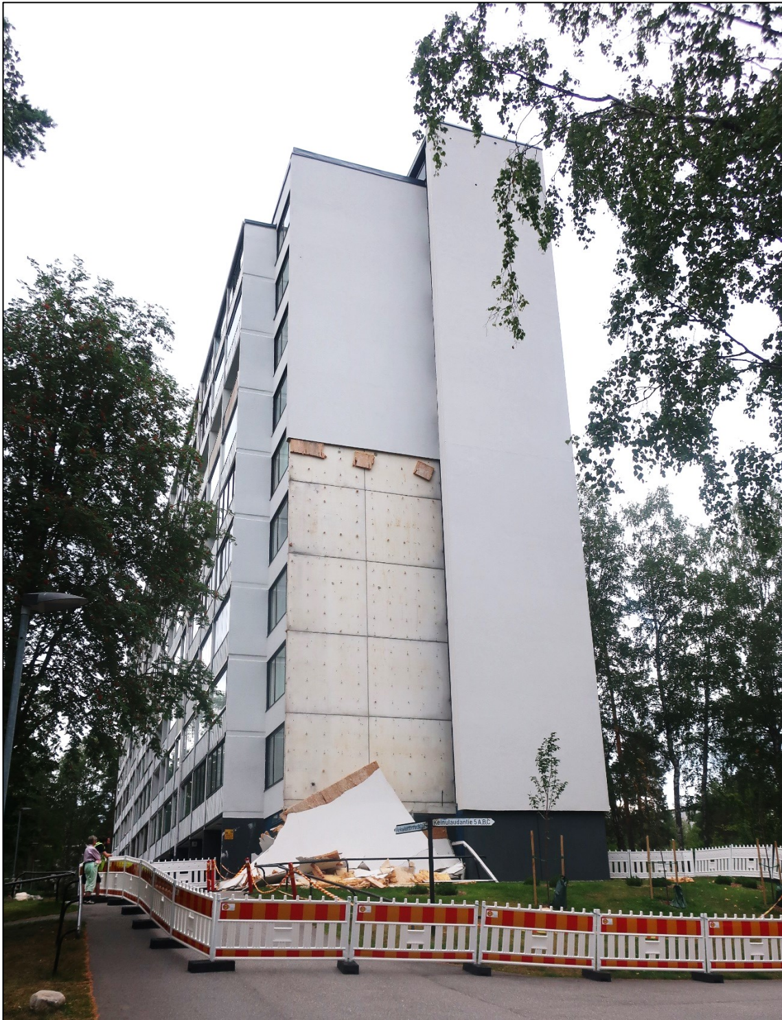
Kuva 1. Yli puolet talon päätyseinän toisen osion paksueristerappauksesta romahti. (Kuva: OTKES)
