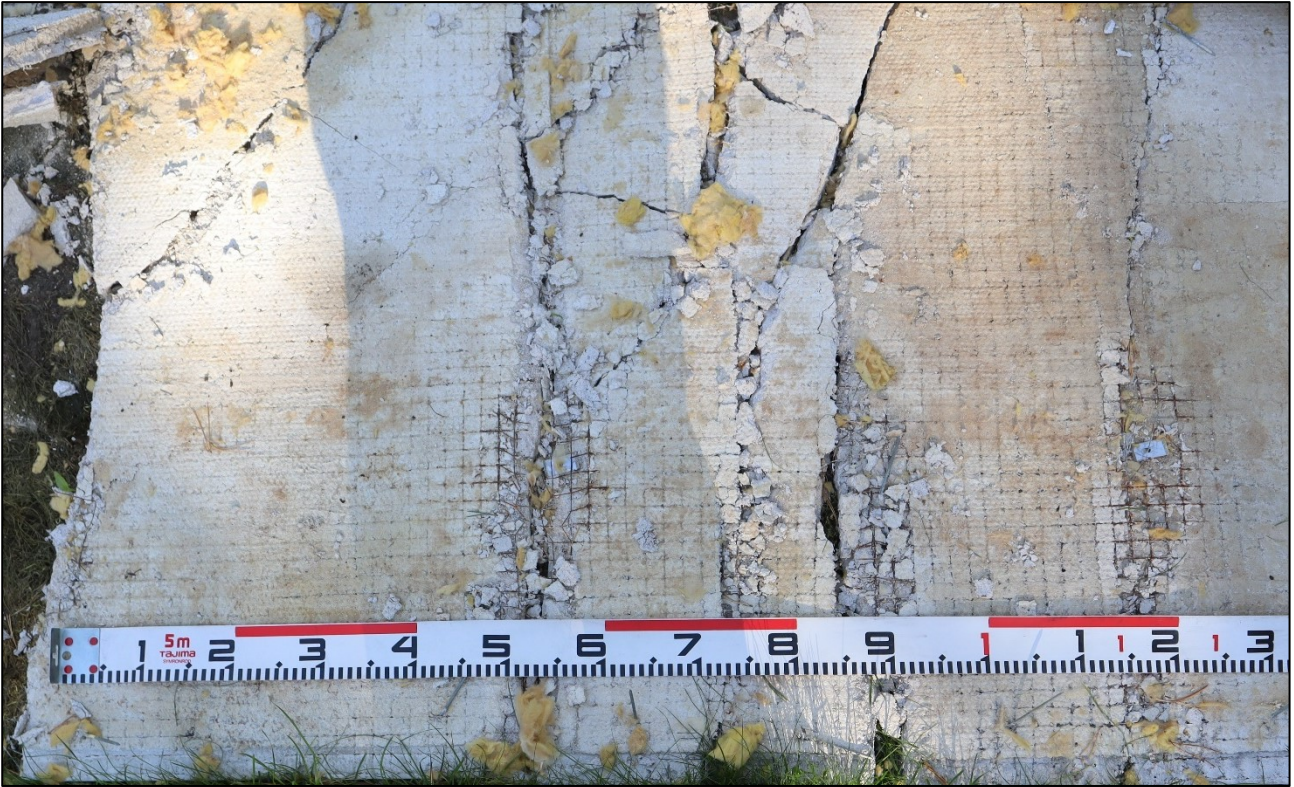
Kuva 11. Rappausverkko oli jäänyt osittain rappauksen ulkopuolelle ja siten alttiiksi korroosiolle. Kuva on paksueristerappauksen rakennuksen seinän puoleiselta osalta. (Kuva: OTKES)
