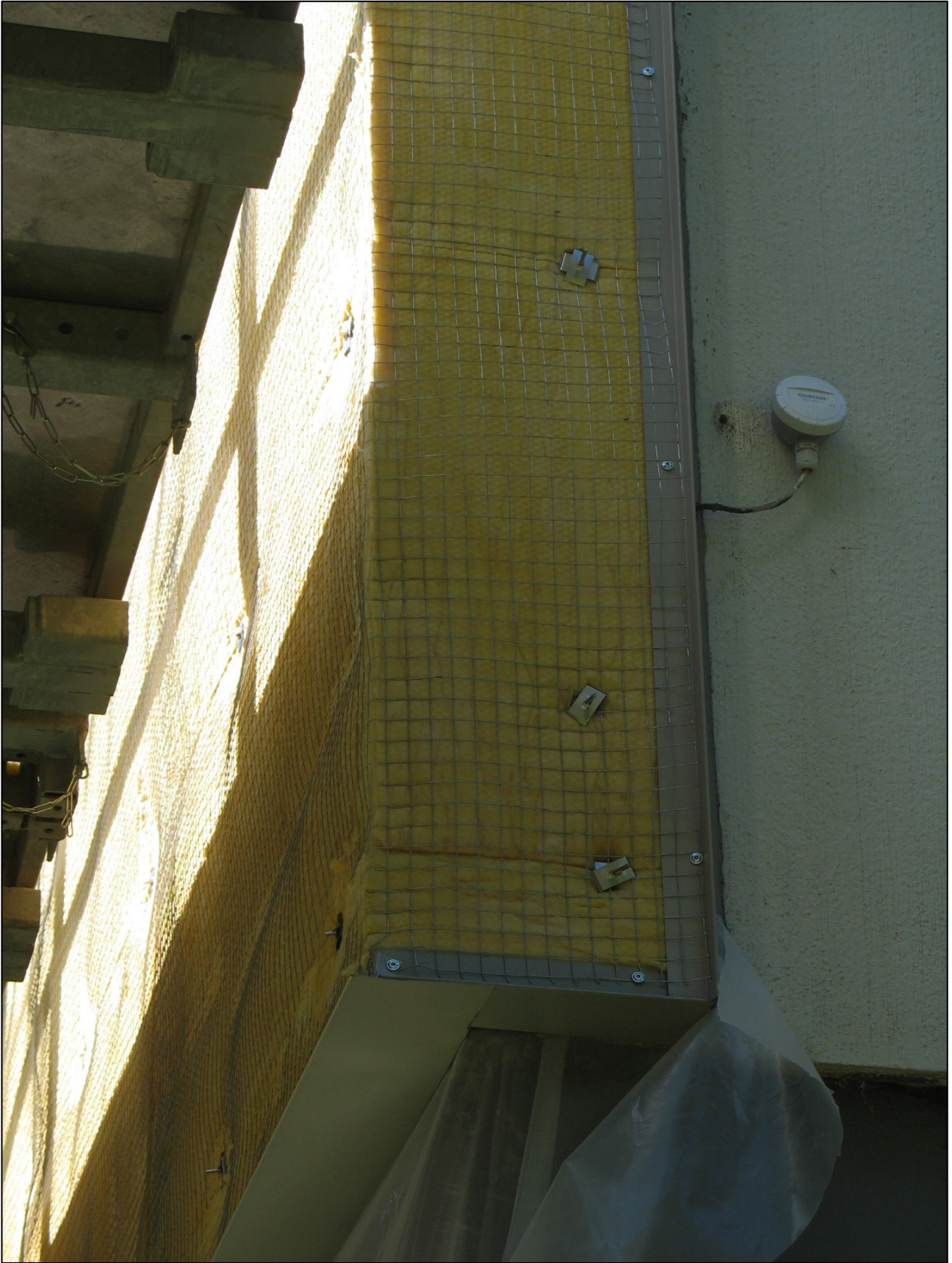
Kuva 10. Rappausverkko oli paikoittain painunut mineraalivillaan ennen rappausta. (Kuva: Taloyhtiö)
