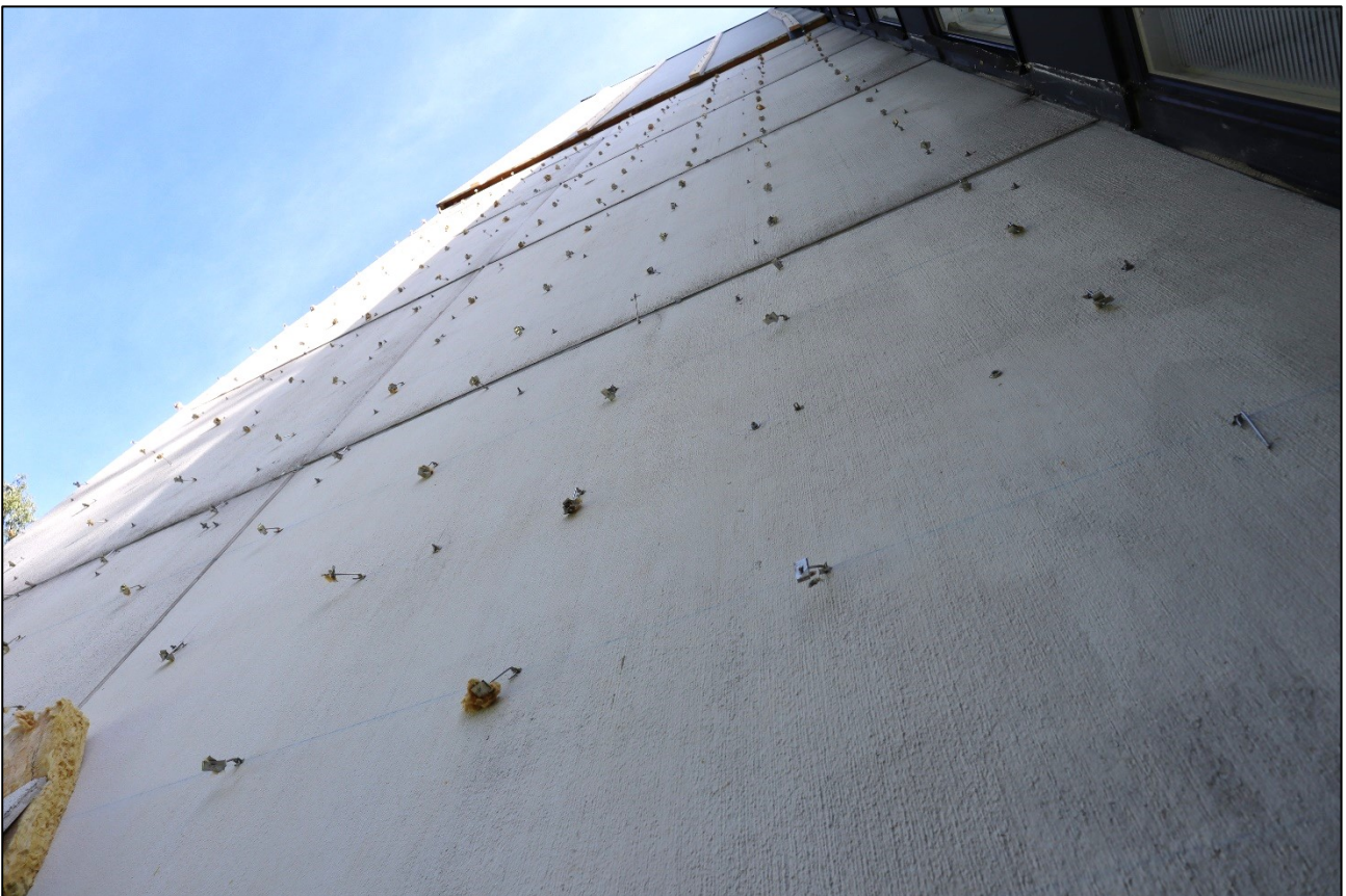
Kuva 8. Kiinnikkeitä seinän betonielementeissä rappauksen romahtamisen jälkeen. (Kuva: OTKES)
