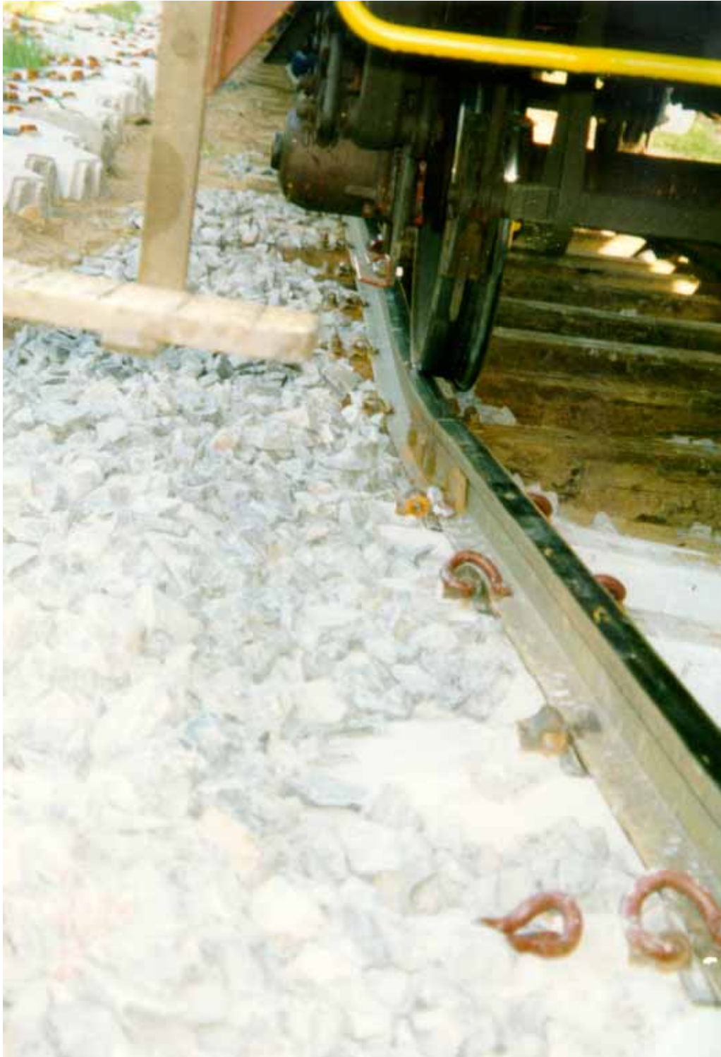
Kuva 7. Kiilarakenteessa tilapäiset puuratapölkkyt ovat käytännössä tiivistämättömän rakenteen päällä ilman sivuttaistuentaa. Raskaan tavarajunan alla kiilarakenteen puuratapölkkyjen kohdalla rata antoi enemmän periksi kuin uusien betoniratapölkkyjen kohdalla. Rajapintaan tuli junan liikettä vastustava "ylämäki". Sivuttaistuennan puuttuessa puuratapölkkyt aikoivat siirtyä sivusuunnassa ja kiskojen näkyvään saumakohtaan tuli mutka, josta useimmat vaunut suistuivat kiskoilla (Pieksämäki 10.6.1996).
