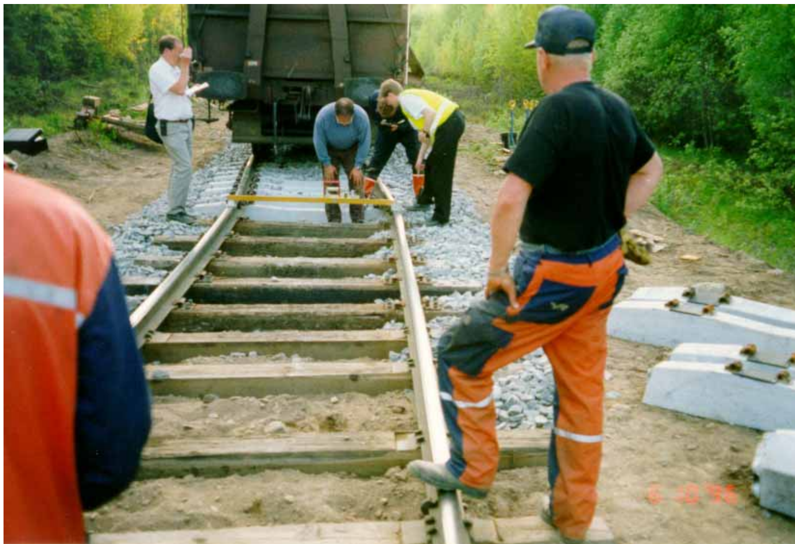
Kuva 6. Tavarajunan 23. vaunun etuteli suistui puu- ja betoniratapölkkyjen rajakohdassa kiskojen vasemmalle puolelle. Veturinkuljettaja ei huomannut tapahtumaa, vaan juna jatkoi matkaa useita satoja metrejä. Junan 27. vaunu ja tätä seuraavat viisi vaunua suistuivat rajakohdasta kiskojen oikealle puolelle (Pieksämäki 10.6.1996).
