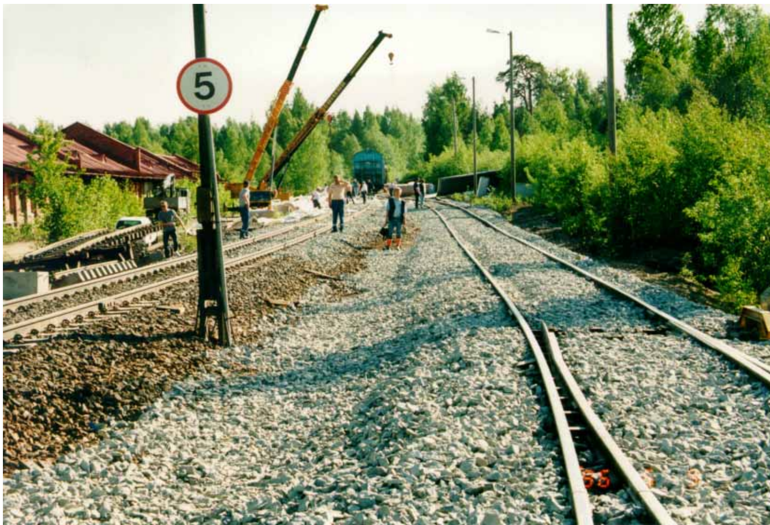
Kuva 1. Nokian ratapihalla paperilastissa olleen tavarajunan 29. vaunu suistui kiskoilta oikealla näkyvän vaihteen kohdalla. Veturinkuljettaja ei voinut huomata tapahtunutta ja juna jatkoi matkaa. Suistunut vaunu kallistui voimakkaasti seuraavassa vaihteessa joutuessaan ylittämään kiskon. Tällöin paperilasti putosi vasemmalle ratapenkereelle. Juna jatkoi edelleen matkaa, jolloin kahden seuraavan vaunun kuorma kaatui radan oikealle puolelle (Nokia 9.6.1996).
