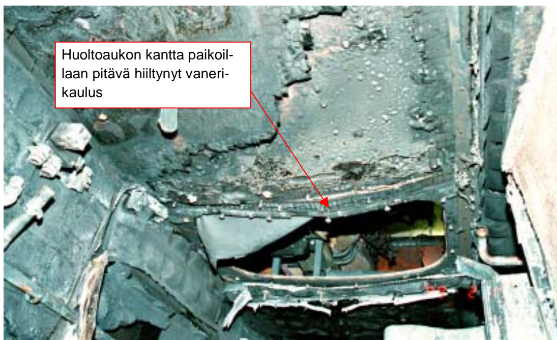
Kuva 6. Moottoritilan katto-osassa näkyy huoltoaukko, jonka kansi oli pudonnut palon sammuttua moottorin päälle. Kuvassa näkyy moottoritilan vasemman puolen kattoa, jonka palovauriot olivat oikean puolen vaurioita pahemmat.
