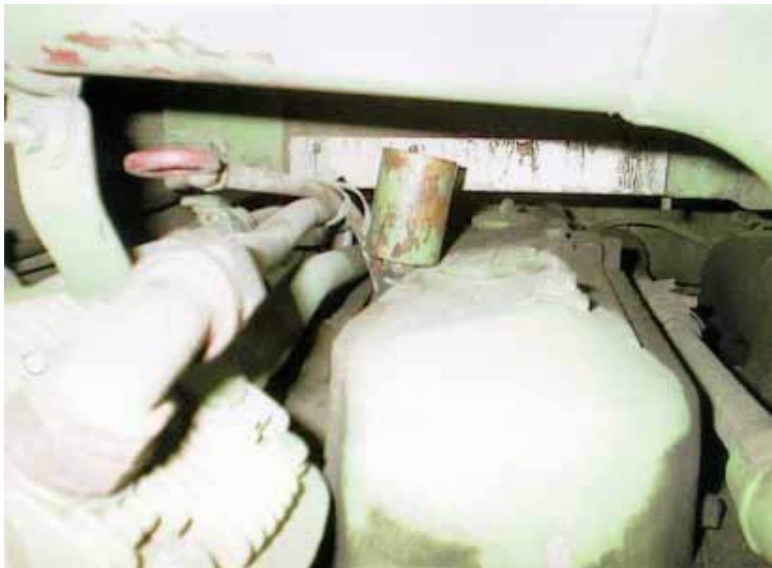
Kuva 4. Kuvassa paluuputkesta irronnut säiliö. Säiliön alkuperä ei ole selvinnyt.
