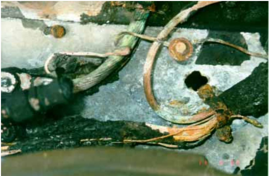
Kuva 8. Kuvassa oikealla laturin kaapelit ja niiden metallinen kiinnityspanta, joka oli oikeakosulun seurauksena sulanut irti moottoritilan seinästä.
