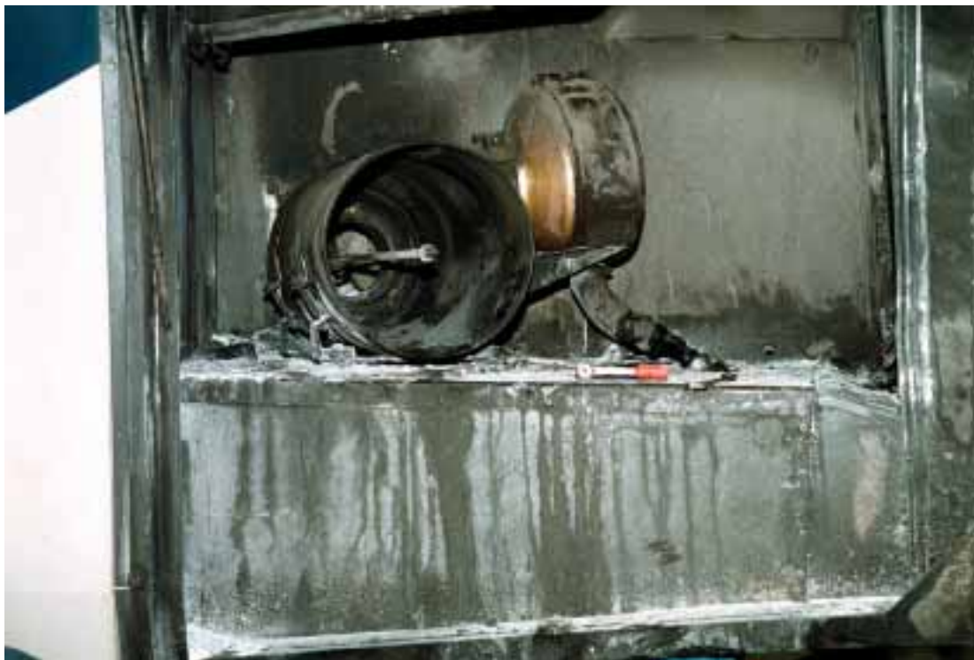
Kuva 12. Kuvassa ilmansuodattimet. Oikealla sykloni, jonka muoviosat olivat sulaneet ja vasemmalla paperielementillä varustettu suodatin.
