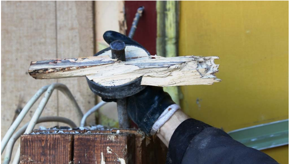
Kuva 22. Puun murtuminen palkin alareunan rengasvaarnakiinnityksen alueelta. (Kuva: poliisi.)
