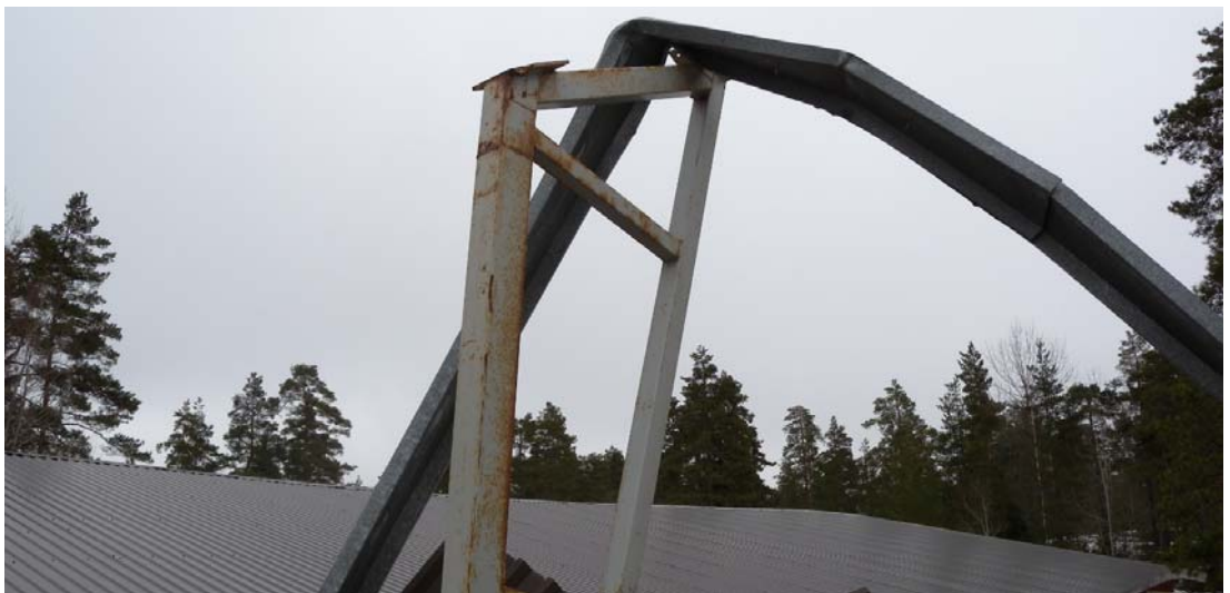
Kuva 31. Lähes pystyyn jäänyt kolminivelristikon seinäosa, josta katto-osa on irronnut pulttiliitosten petettyä.
