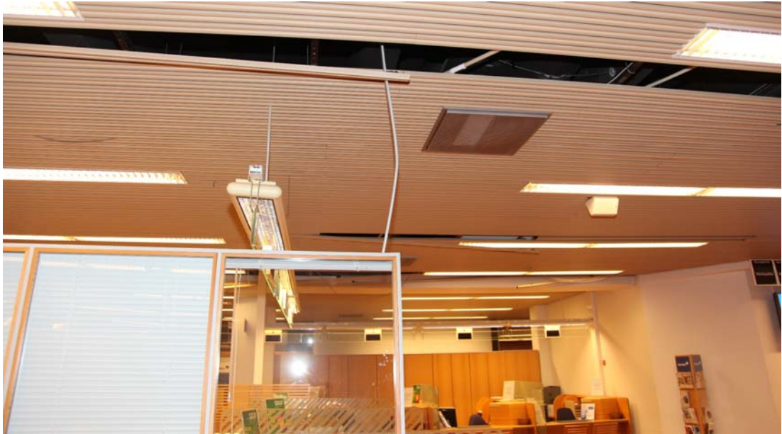
Kuva 36. Sivulle taipunut alumiinitanko. Alakattoa on avattu tutkimuksia varten. (Kuva: poliisi.)
