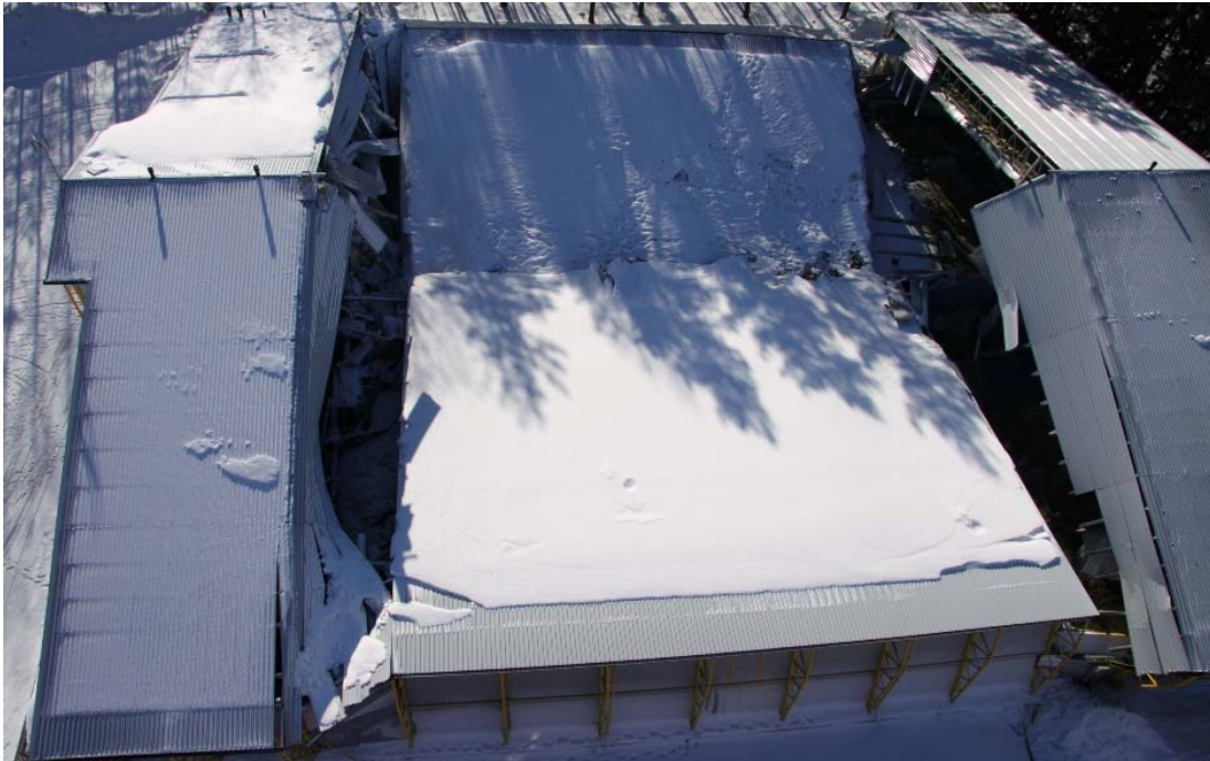
Kuva 9. Halli ylhäältä päin kuvattuna. (Kuva: pelastuslaitos 12.3.2010.)
