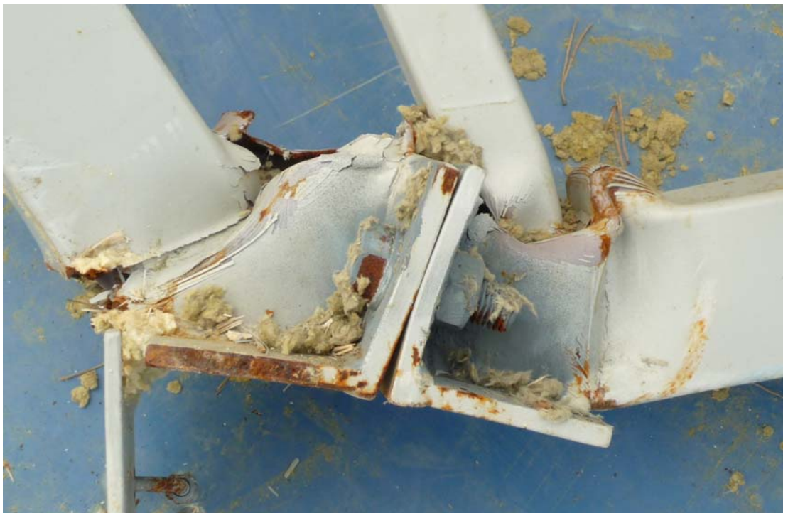
Kuva 14. Katon putoamisesta aiheutuneita vaurioita alapaarteen liitoksessa.
