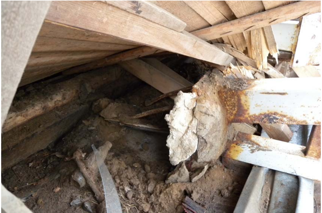
Kuva 30. Ratsastusmaneesin rakenteissa oli runsaasti ruostetta.
