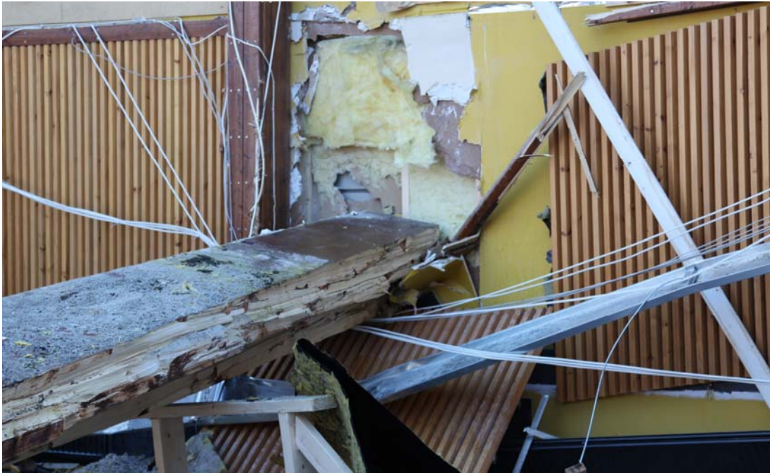
Kuva 20. Tuelta pudonnut palkin eteläpää taittui palkin pituussuunnassa. (Kuva: poliisi.) Bild 20. Balkens södra ände som hade fallit av stödet bröts i balkens längdriktning. Picture 20. The southern end of the beam dislodged from the support and was folded lengthwise.
