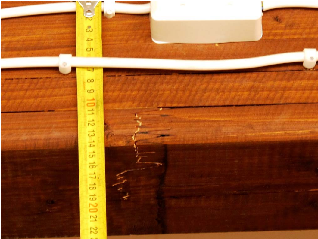
Kuva 24. Paikalleen jääneen palkin alimmissa lamelleissa sormijatkoksen vieressä havaittu halkeama. (Kuva: poliisi.)
