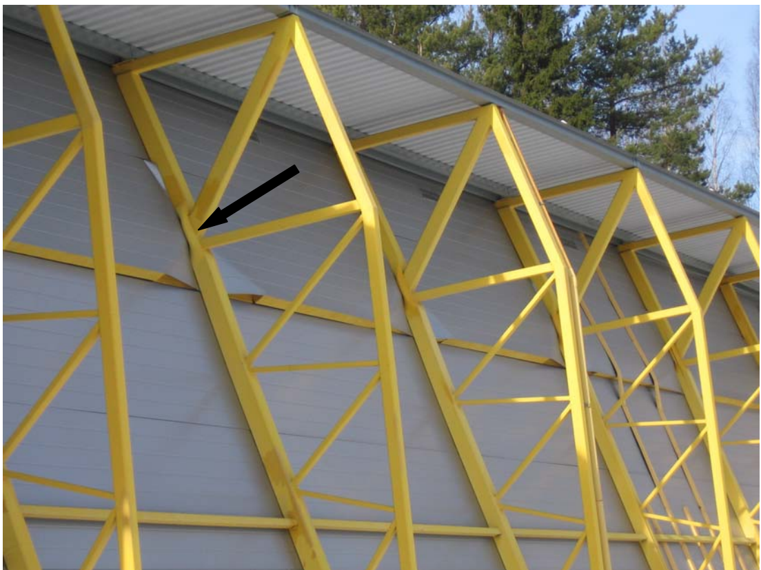
Kuva 10. Useimmat pilarit olivat puristuneet kasaan sen ja alapaarteen välisestä liitoksesta.
