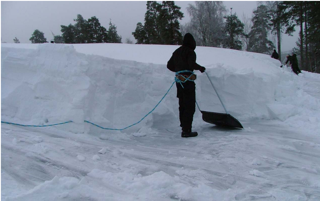
Kuva 34. Suurella osalla kattoa oli hyvin paksu lumikerros. (Kuva: Espoon kaupunki.)
