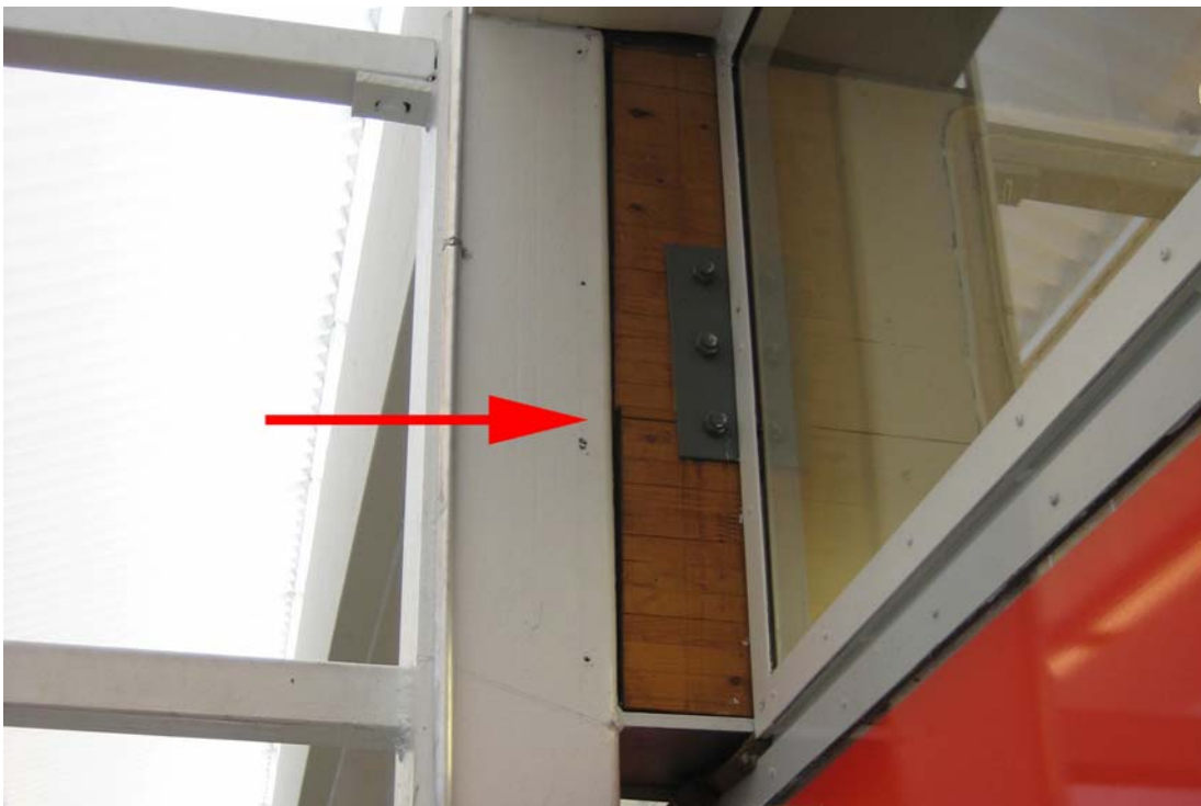
Kuva 39. Halkeama on avautunut alimman pultin kohdalta. (Kuva: Mikael Lindberg.)
