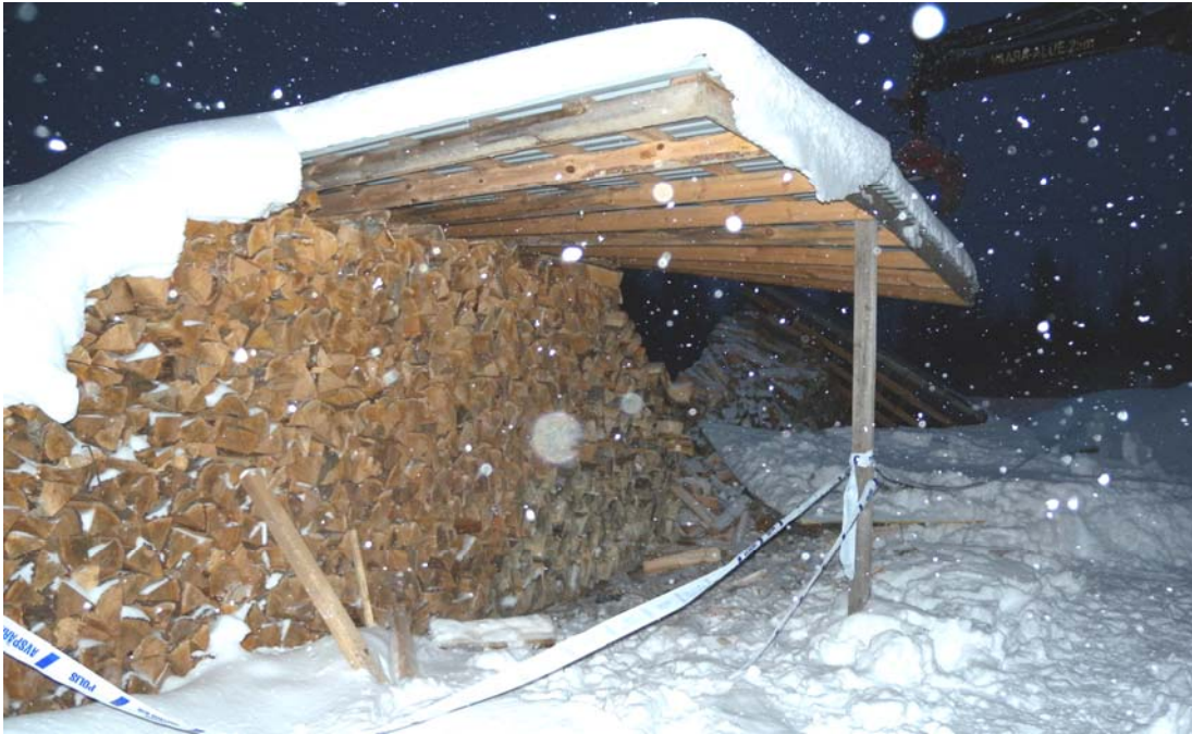
Kuva 41. Polttopuiden suojaksi oli rakennettu irtonaiset puukehikkoiset peltikatteet. Sortunut osa on takana oikealla.
