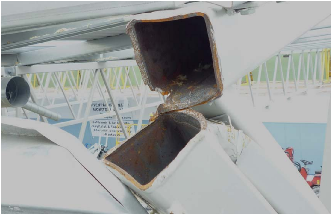
Kuva 13. Vaurioitunut jatkoshitsausliitos pääkannattajan yläpaarteessa harjan kohdalla.
