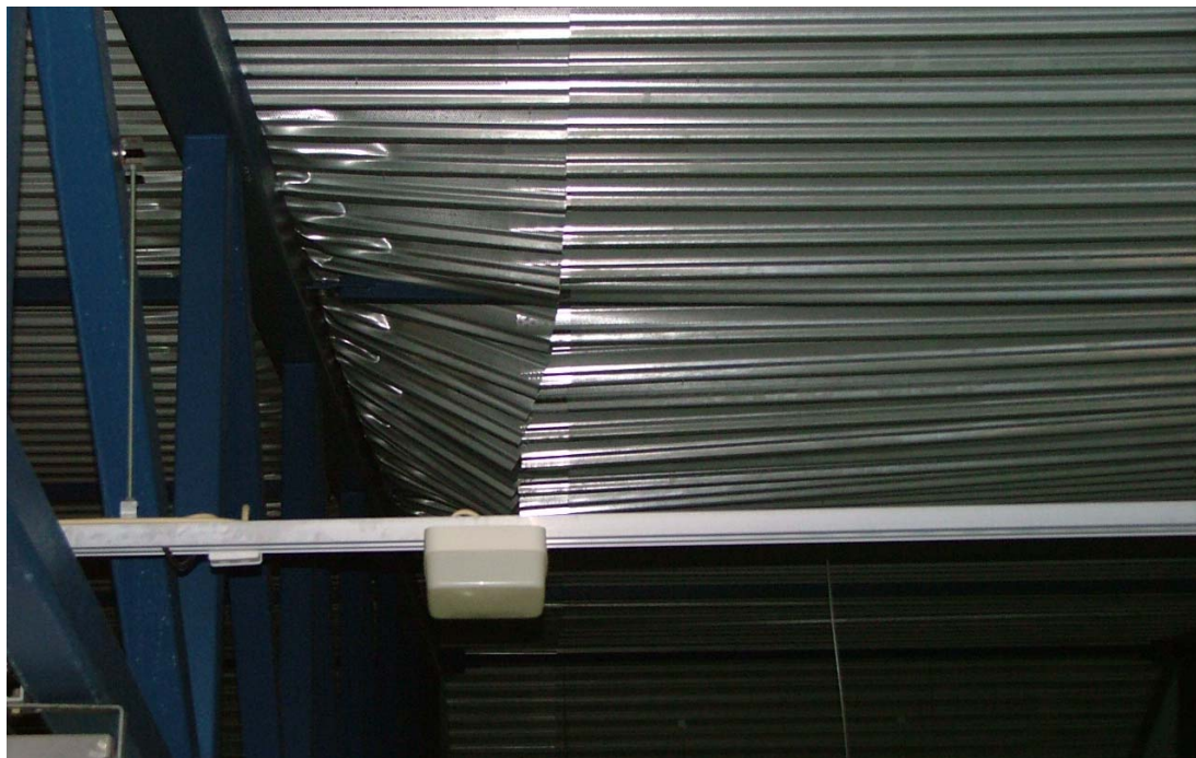
Kuva 33. Katon vaurioituneita profiilipeltejä. (Kuva: Espoon kaupunki.)
