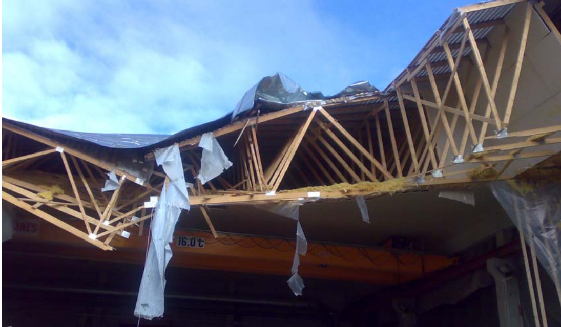
Kuva 32. Teuvalla sortuneen tuotantotilan ylös jääneitä kattoristikoita.
