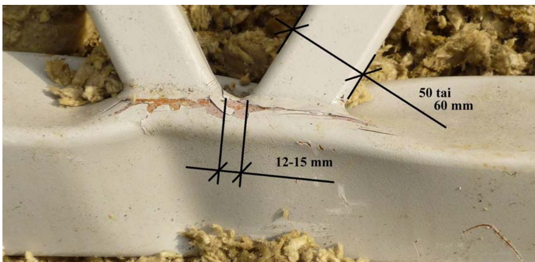
Kuva 12. Paarreputken vaurioitunut diagonaaliliitos myötökuvioineen. Liitoksen vapaaväli oli 12–15 mm.
