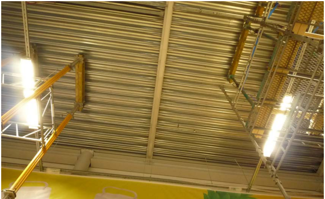
Kuva 35. Katon ohutlevy painui kasaan keskituen kohdalla. Tuennat on tehty vaurion jälkeen.
