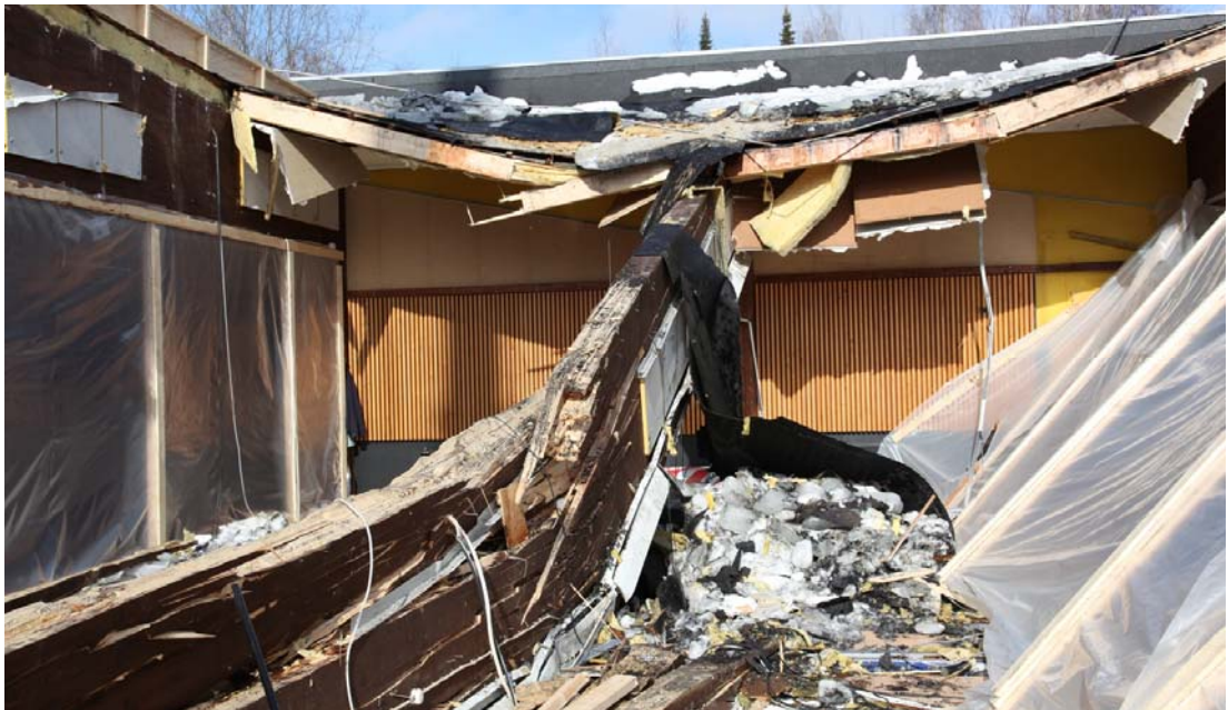
Kuva 19. Palkin pohjoispää jäi tuelle. (Kuva: poliisi.)
