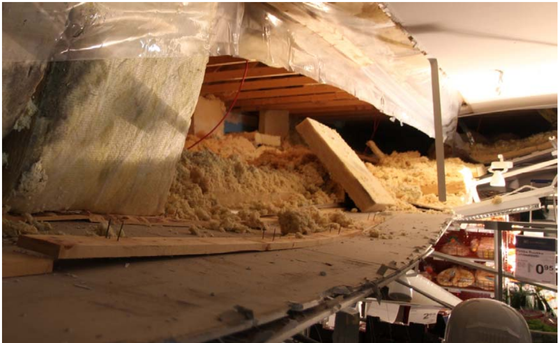
Kuva 5. Pudonnut sisäkatto jäi suurelta osin kaupan hyllyjen varaan.
