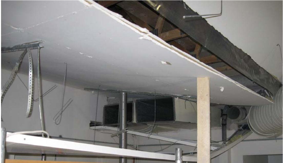
Kuva 2. Varaston pudonnut katto. Katto jäi seinän vieressä seinän läpi tulevan ilmastovaihtoputkiston varaan. Kattorakenteessa alimpana ollut alaslaskettu 600 mm x 600 mm levyistä koostunut kipsilevykatto oli kuvaa otettaessa jo purettu.
