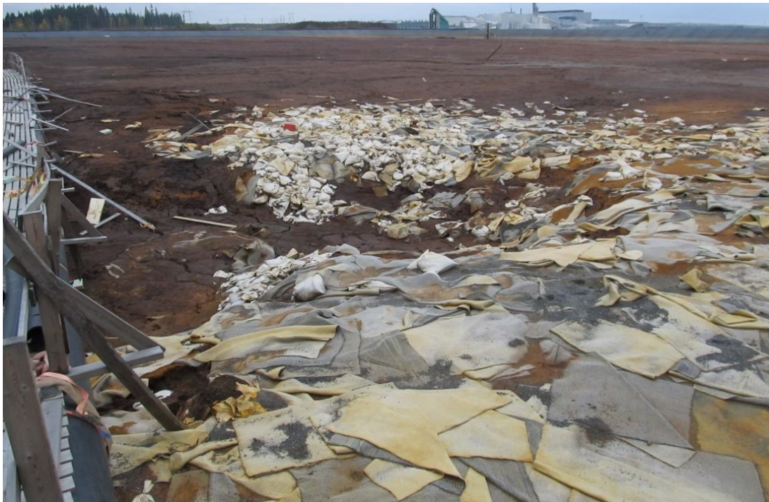
Kuva 3. Ykköskipsisakka-altaan vuotokohta ja vuodon tukkimiseen käytettyjä bentonittimattoja ja kivituhkasäkkejä.
