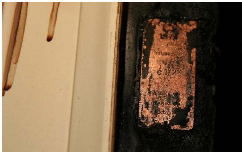
Kuva 9. Alkuperäisen palo-oven hyväksyntämerkintä ja luokitus.
