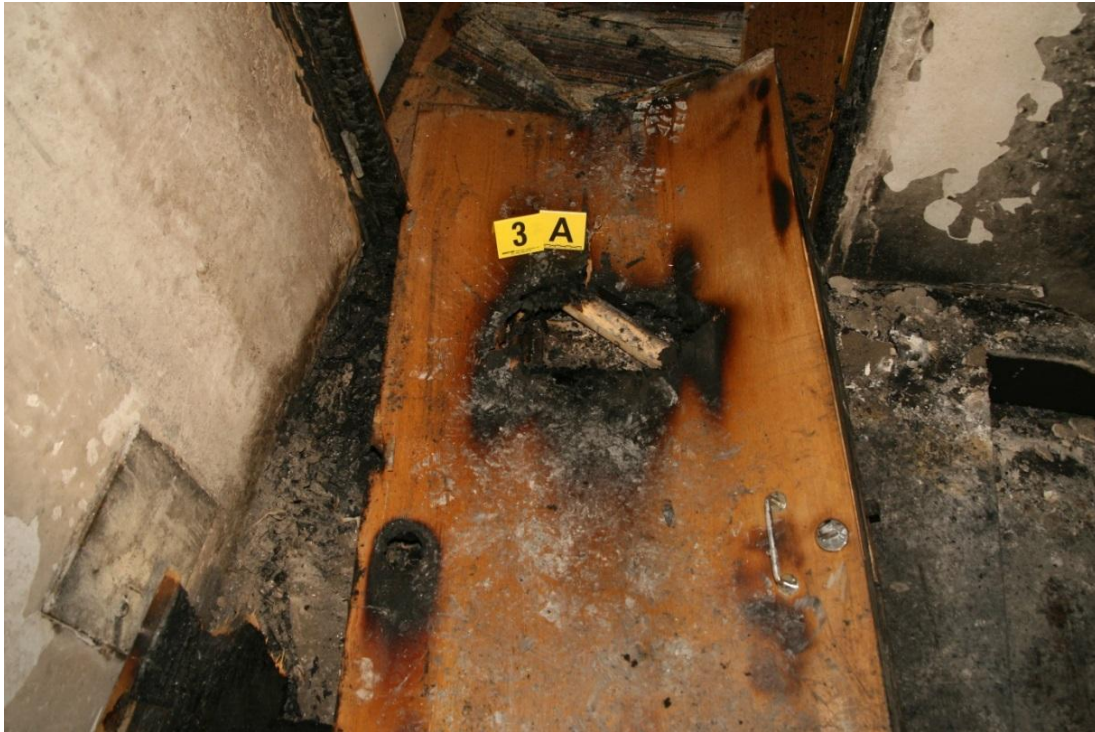
Kuva 4. Palanut ovi kolmannesta asuinkerroksesta. Kuvassa näkyvät palovauriot ovat asunnon puolella.
