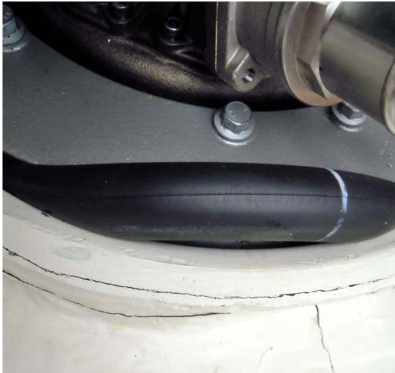
Kuva 27. Vetolaitteen ja lasikuituisen asennuskauluksen välissä oleva O-rengas oli luiskahtanut ulos urastaan aiheuttaen ylimääräisen vuotokohdan. Huomaa myös laminaatin murtuminen asennuskauluksen kohdalla.
