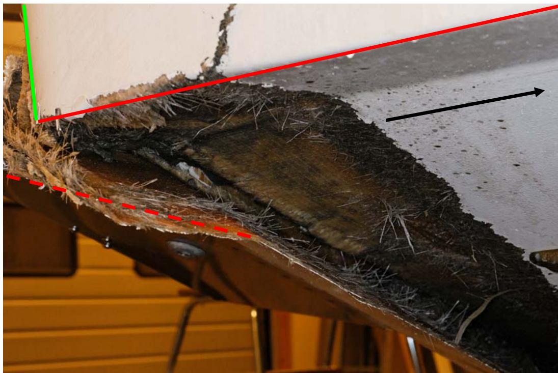
Kuva 20. Repeämä veneen pohjassa. Kuvaan on merkitty vihreällä viivalla veneen peräpeilin ja laidan välinen kulma, punaisella yhtenäisellä viivalla veneen palle, punaisella katkoviivalla peräpeilistä pohjaan ulottuva laminaatti, joka on repeytynyt irti varsinaisesta pohjalaminaatista. Mustalla nuolella on merkitty keulan suunta.
