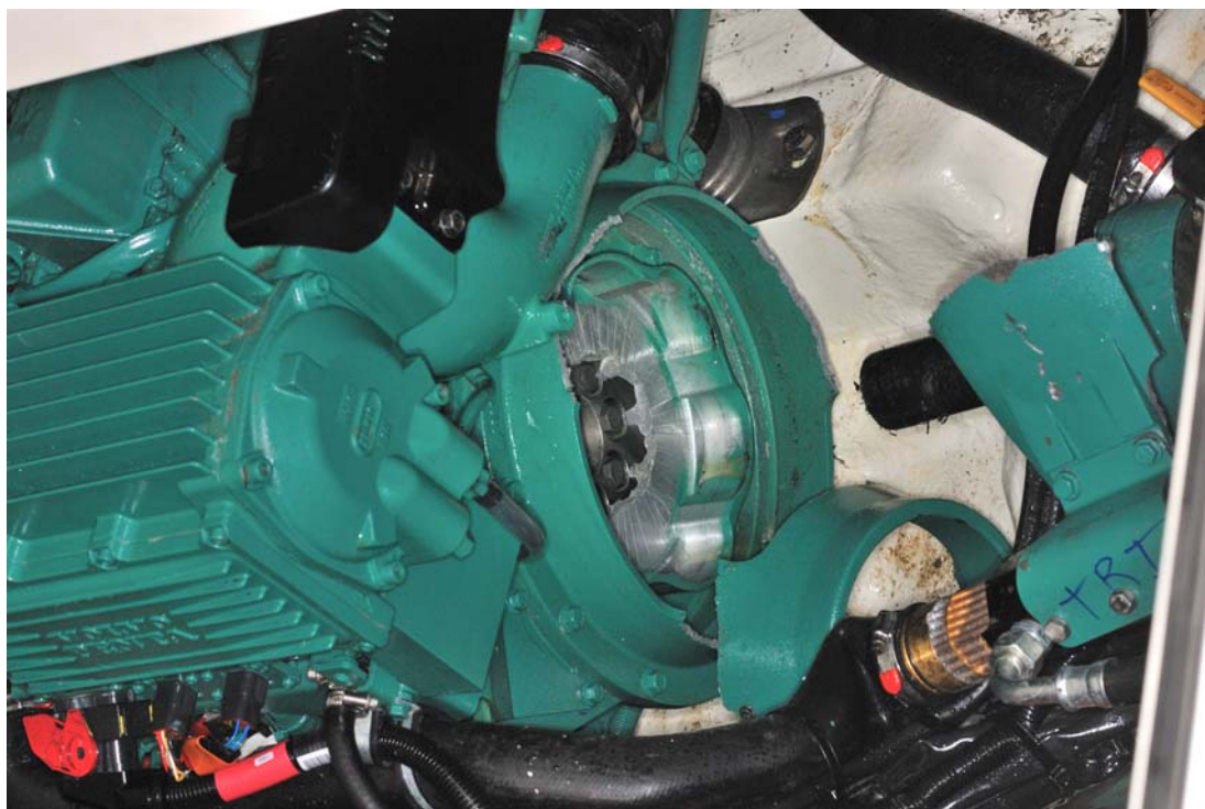
Kuva 18. Murtunut joustokytkin ja akselin rikkoma metallinen kotelo.
