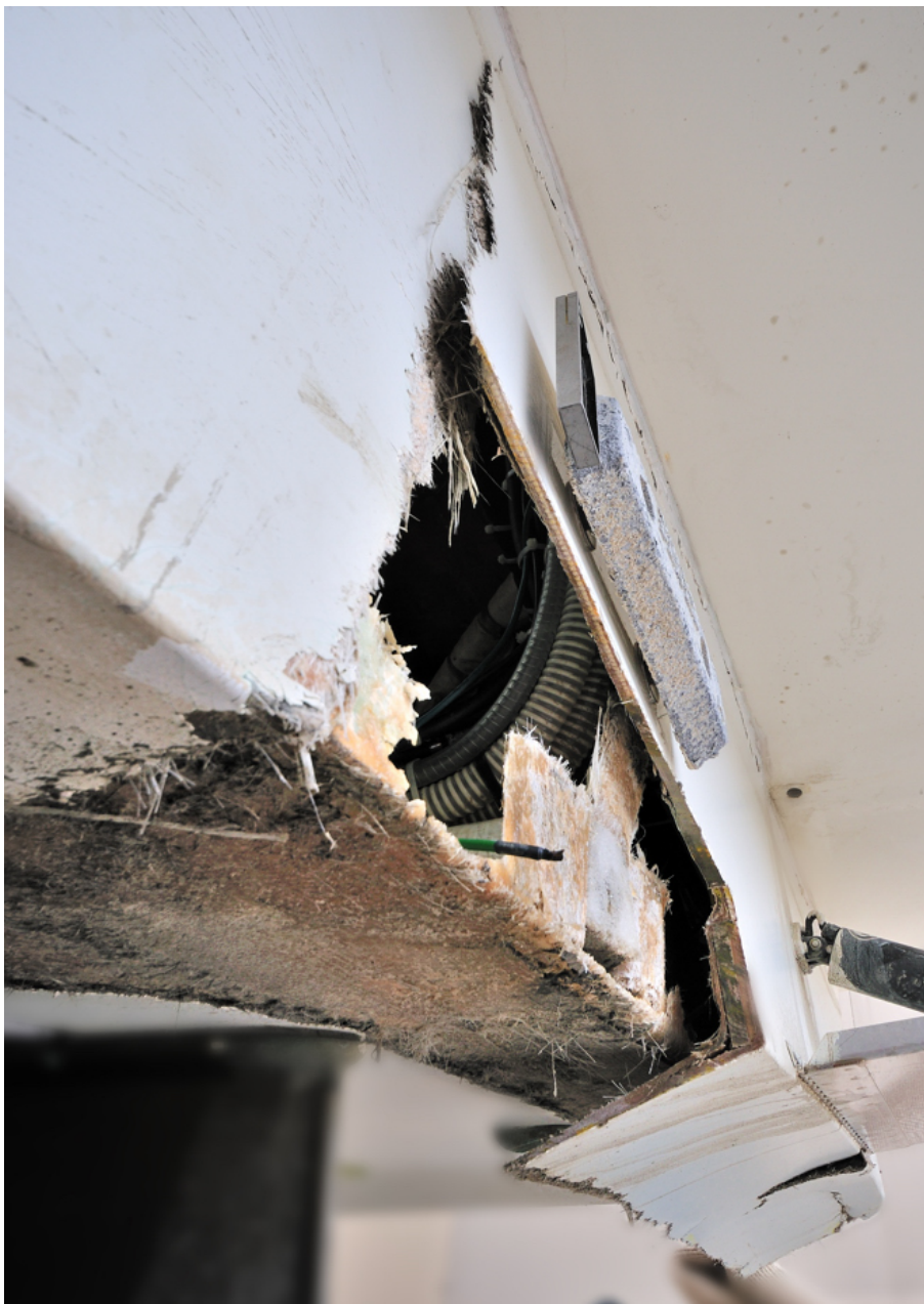
Kuva 29. Näytepalan leikkaamisen jälkeen otetusta kuvasta näkyy selkeästi miten peräpeili ja pohja ovat revenneet irti toisistaan. Lujitekerroksia ei ole vuorotellen limitetty, vaan ensin on tehty peräpeili ja sen päälle (muotissa) on lami-noitu veneen pohja. Irtoaminen on tapahtunut osien välistä saumaa pitkin. Kuvasta näkyy myös huolimattomasti peräpeilin ja IPS-asennusrenkaan vä-lille liitetty polvio.
