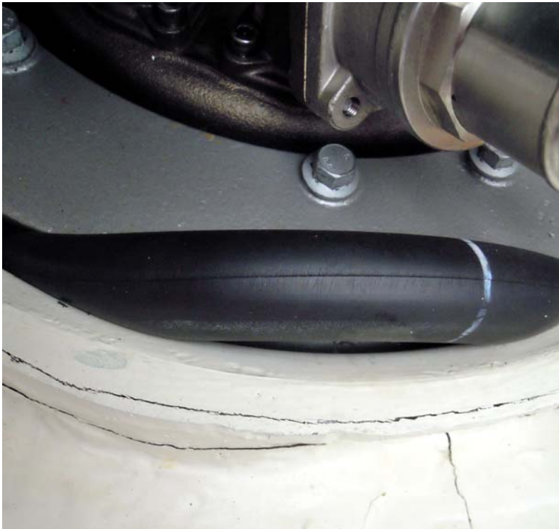
Kuva 23. Vetolaitteen ja lasikuituisen asennuskauluksen välissä oleva O-rengas oli luiskahtanut ulos urastaan aiheuttaen ylimääräisen vuotokohdan. Huomaa myös laminaatin murtuminen asennuskauluksen kohdalla.
