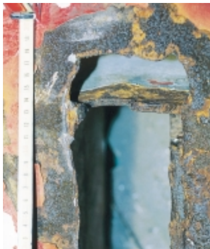
Kuva 12.22 Vasemmanpuoleisen sivulukkolenkin irtoamiseen liittyvä murtuma vaakajäykkäjäen kohdalla.
