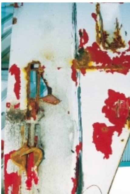
Kuva 8.20 Visiirin takalaipion vaurioita oikealla puolella irronneen sivulukon korvakkeen läheisyydessä.
