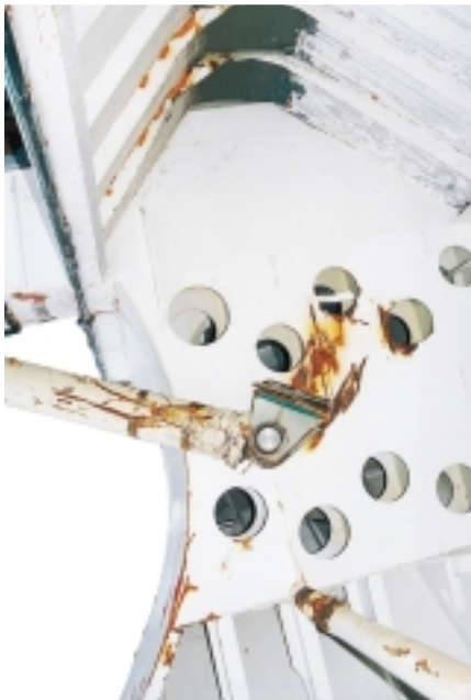
Kuva 8.7 Iskujälkiä visiirin vasemman puolen sisälaipiossa, ylimmässä poikkipalkissa ja rampin yläosan kotelossa.
