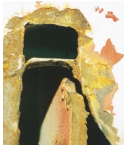
Kuva 12.23 Oikeanpuoleisen sivulukkolenkin irtoamiseen liittyvä murtuma vaakajäykkäjäen kohdalla.
