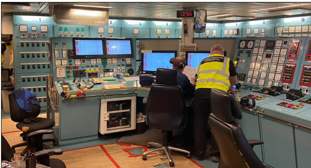
Kuva 11. Amorellan konevalvomo. Kuva on otettu aluksen telakoinnin aikana eivätkä kuvan henkilöt liity onnettomuuteen. (Kuva: OTKES)
