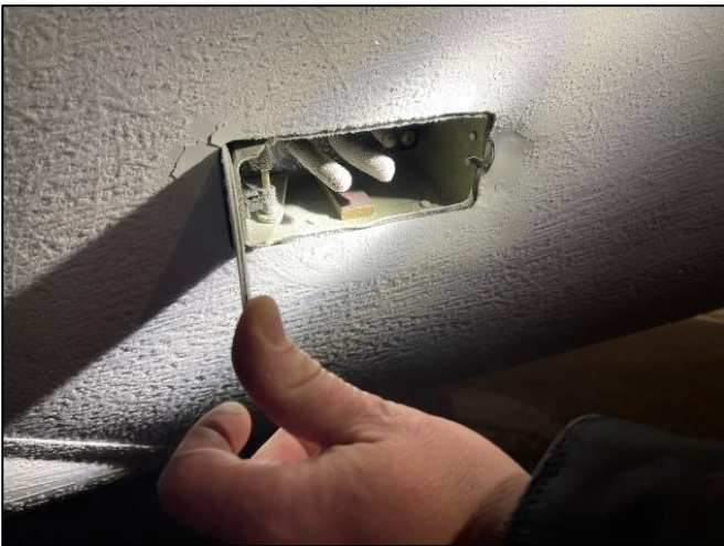
Kuva 5 Lentokoneen maavirtaliittimen pinnit ovat vääntyneet ja ympäröivän rungon peltiin on aiheutunut painauma kytkettynä olleen maavirtakaapelin kiristyessä ennen irtoamista. (Kuva: OTKES)
