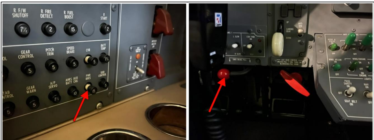
Kuva 6 Lämpövarokepaneeli sijaitsee ohjaamossa vasemman istuimen vasemmalla puolella. Vasemmassa kuvassa nuolella osoitettu jarrujärjestelmän lämpövaroke (PWR BRKS CB) oli yläasennossa eikä jäänyt ala-asentoon mekaanikon suorittamassa toimintakokeessa kolme vuorokautta tapahtuman jälkeen, 8.12.2021. Oikeanpuoleisessa kuvassa on nuolella osoitettu pneumaattisen varajärjestelmän hätäjarrukahva (Emergency Brake), joka sijaitsee ohjaamossa vasemmanpuoleisen istuimen edessä. Hätäjarrukahva sijoittuu kuvassa osittain näkyvän ohjaussauvan taakse, mikä vaikuttaa mahdollisuuteen tarttua kahvaan. (Kuva: OTKES)
