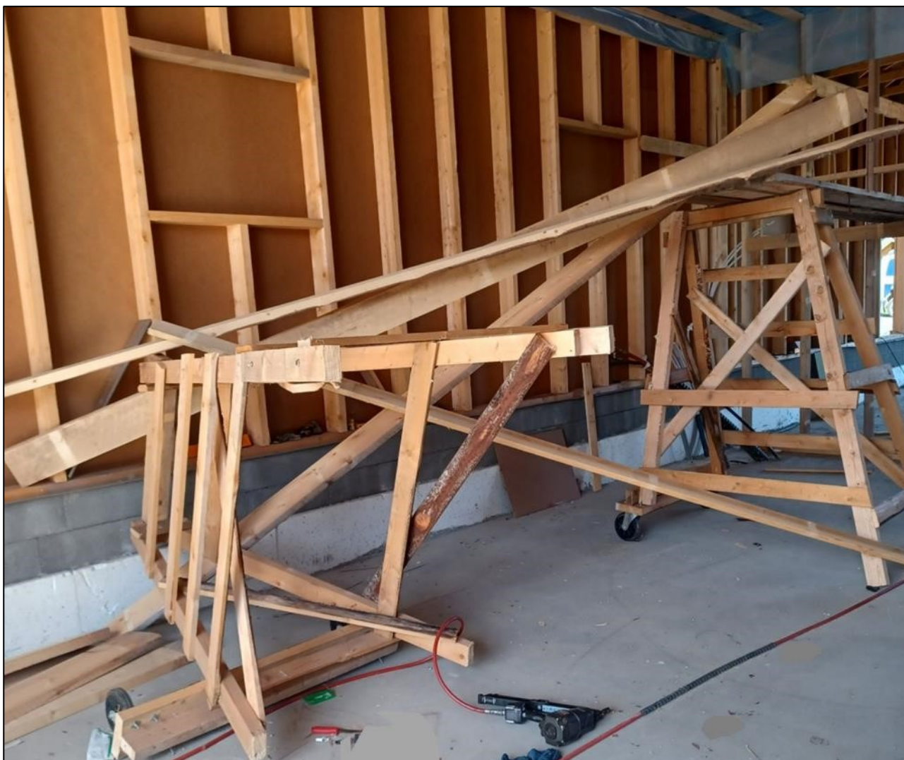
Kuva 33. Onnettomuustapahtumassa käytetty rakennusteline. Vasemmalla työtason alta kaatunut telinepukki. Oikealla pystyyn jäänyt ehjä telinepukki. (Kuva: poliisi)
