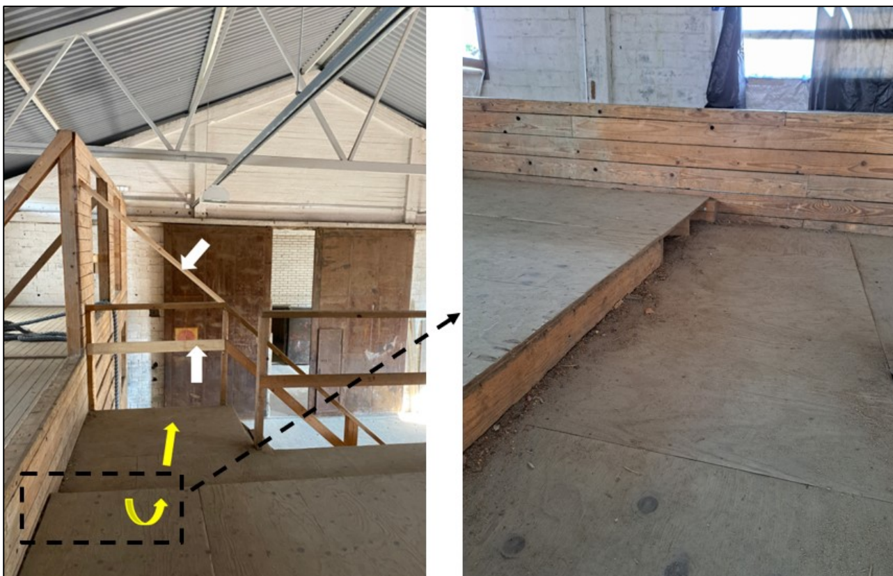
Kuva 27. Onnettomuuspaikka. Vasemmassa kuvassa keltaiset nuolet kuvaavat uhrin liikettä. Uhri horjahti ylätasanteella olevan askelman reunalla. Valkoiset nuolet osoittavat onnettomuuden jälkeen kaiteeseen lisättyjä puurakenteita. Oikeassa kuvassa näkyy askelman tasoero toisesta suunnasta kuvattuna. Tasoeron korkeus on 11 cm. (Kuva: OTKES)
